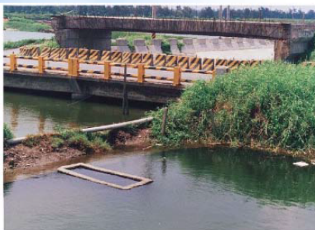
新舊橋樑 新舊橋樑明顯對比，下陷影響增加計會成本付出。
