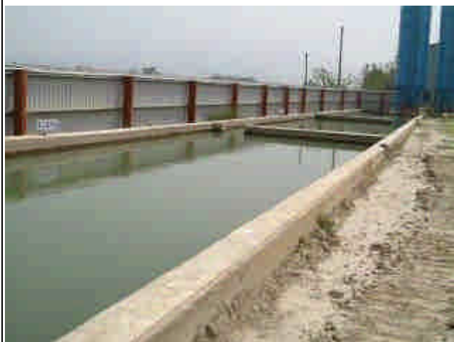
D.廢水處理設備
