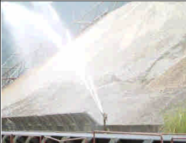
E.自動灑水設施(2)
