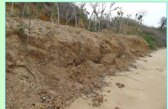
新植防風林土堤崩塌
