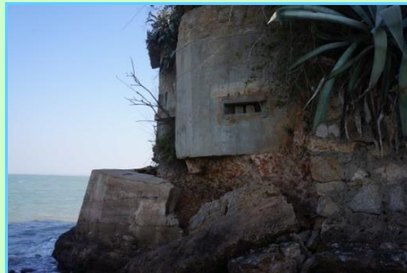
碉堡基礎崩塌
