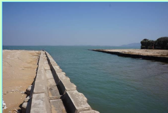
堤岸浸入海面
