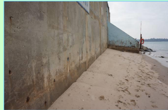
自來水廠海底管線口
