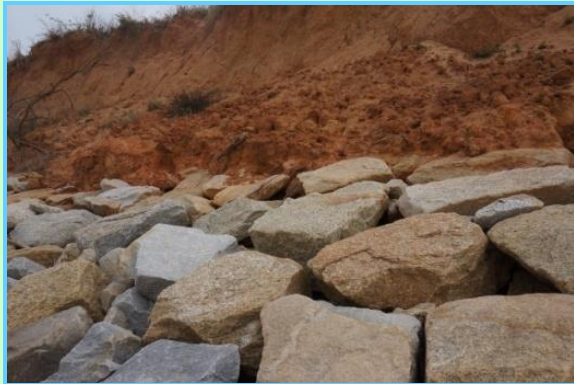
濱海自行車道沿岸土石崩落
