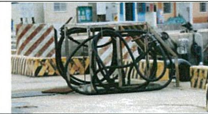
⑲漁船加油設施
