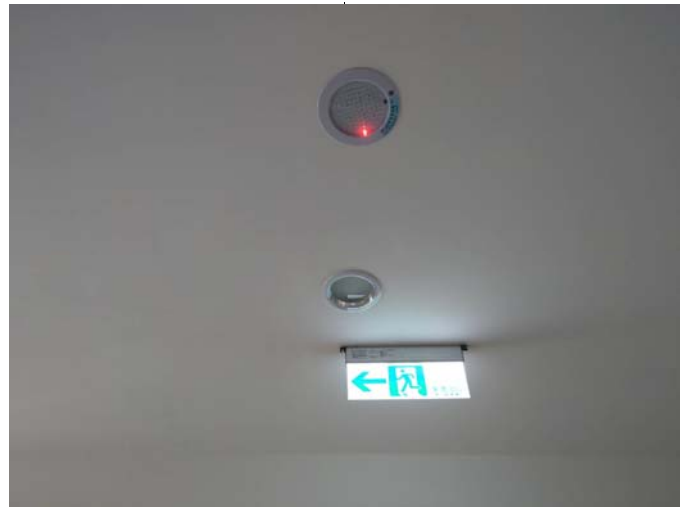
照片說明：消防設備
