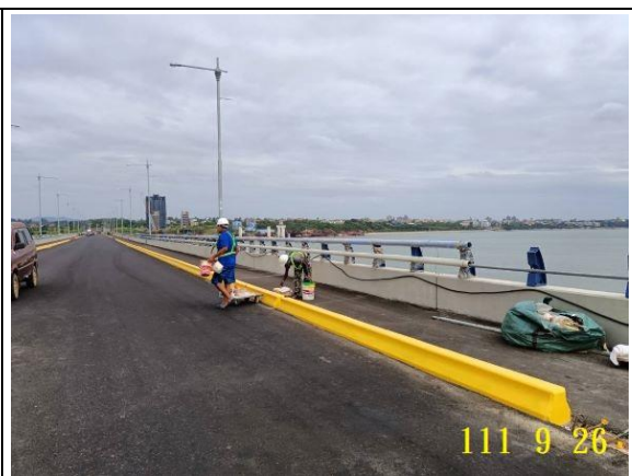
相片 8、大金段引橋橋面緣石繪設障礙物線
