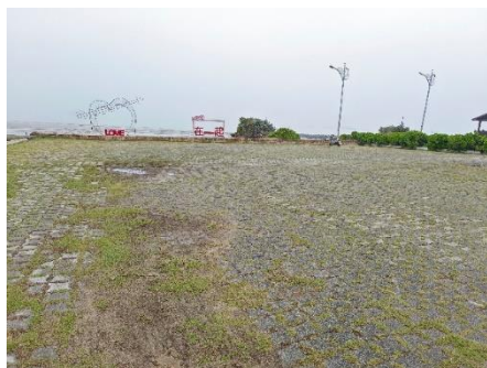
既有鋪面沉陷破損
