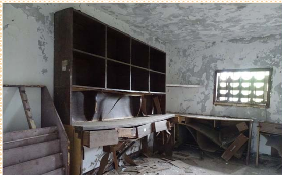
營舍內設施損壞
