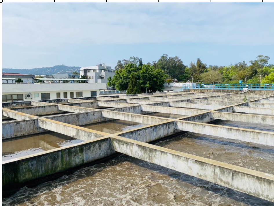
太湖水資源中心-活性污泥氧化深渠
