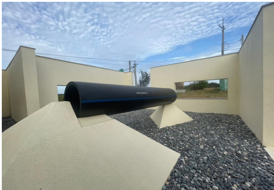
大陸引水海管使用 HDPE 管
