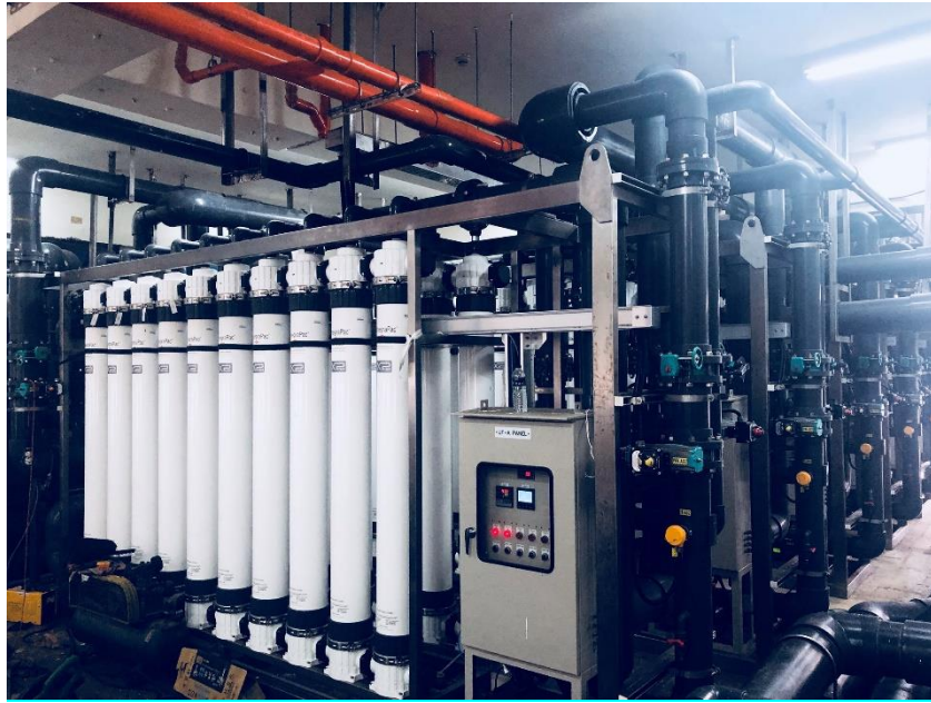
海淡廠處理設備
