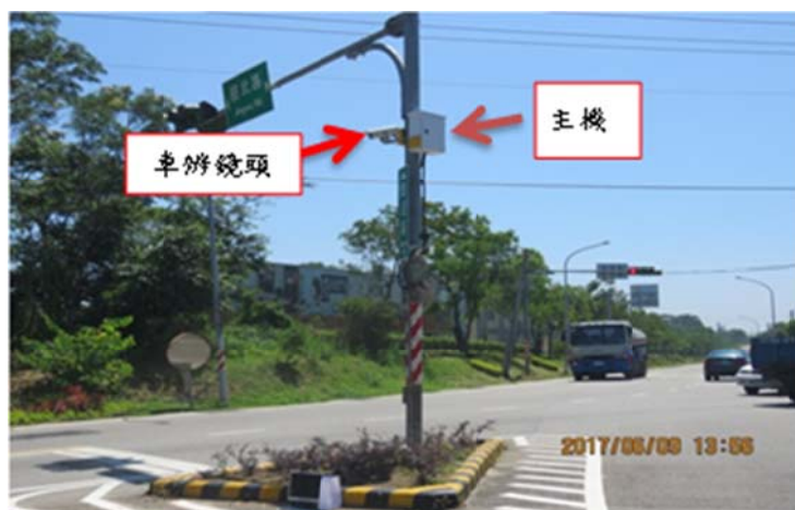
圖 6.4 固定式車辨系統安裝完成圖
