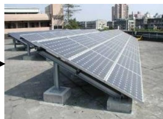
太陽光電組列 (PV Array)
