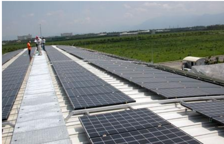
屏東縣 120kWp (多晶矽)
