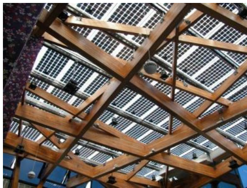
客委會新瓦屋集會堂15.08kWp
