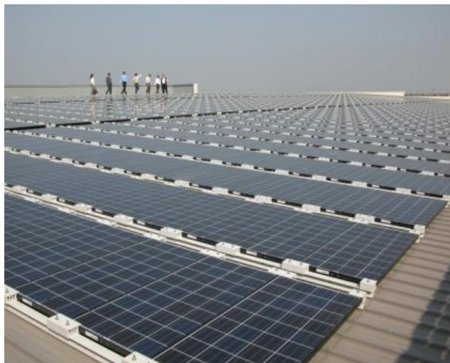
台南市 228.8kWp (多晶矽)
