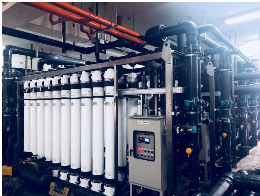
海淡廠處理設備
