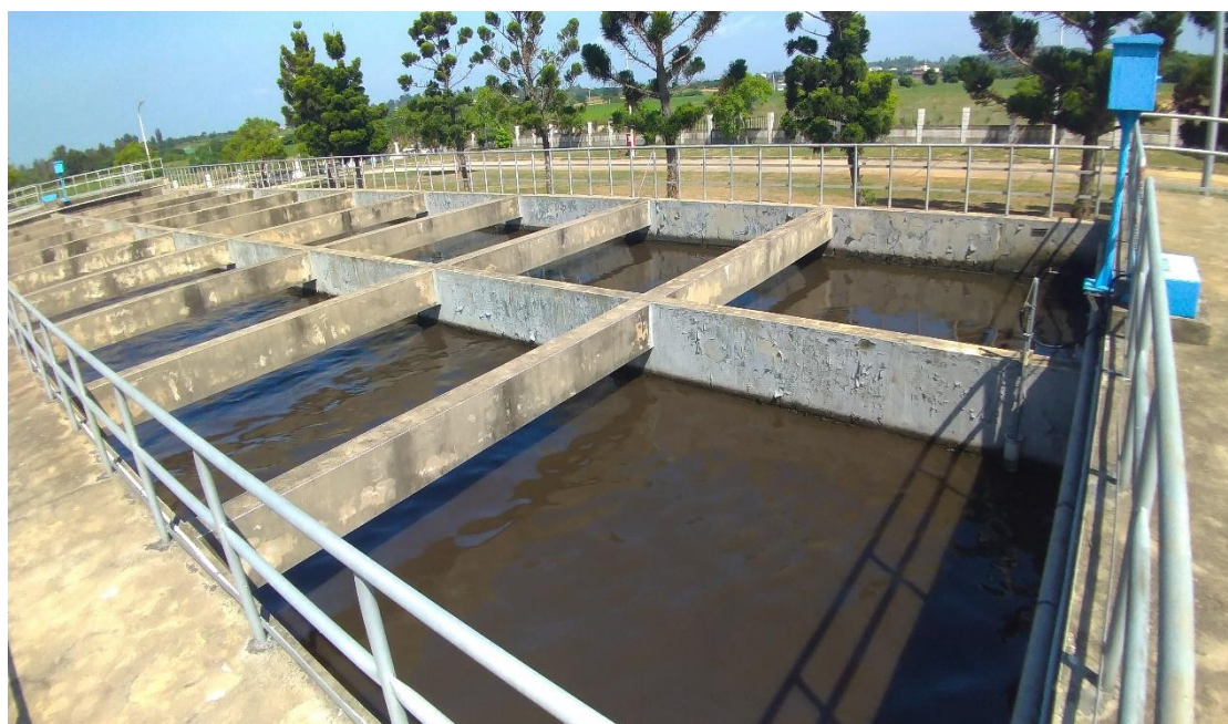
榮湖水資源中心-活性污泥氧化深渠
