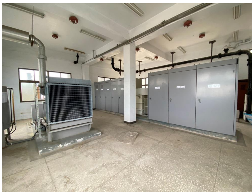
發電機房及高低壓設備
