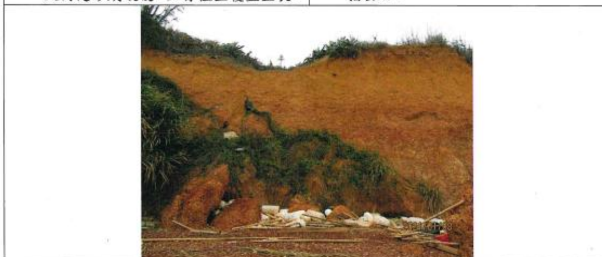
圖5、崖體上部風化為紅土，深度約50公分至2公尺。此段崖體緊鄰車轍道，紅土質地較鬆軟，而右側風化紅土有懸空情形。
