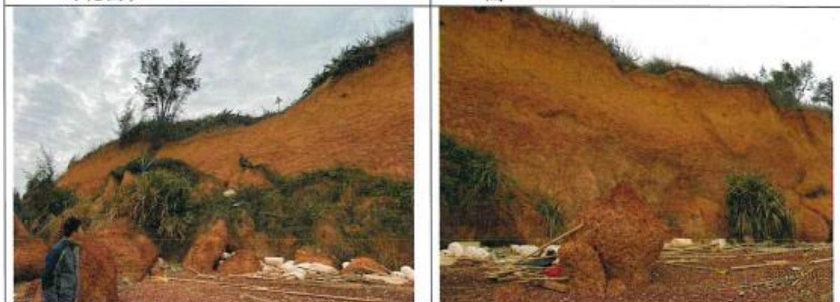
圖3、崖體左側下部現有大型貓公石抵禦浪潮，並有土沙於基部至斷崖中段約3公尺高處形成緩坡，上有植生覆蓋生長。
