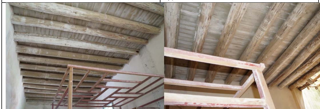
照片 11 主棟一樓次間房樑局部損壞
