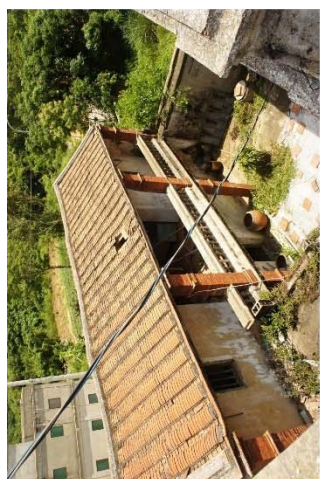
前迴向洋樓二樓正立面，屋頂破損
