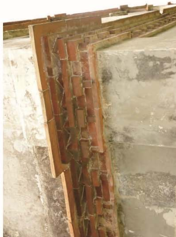
6. 主棟洋樓背立面 磚砌出斜磚汙損。
