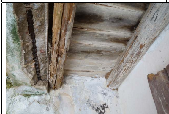
照片 27 前迴向一樓騎樓次間樑外部白蟻嚴重蛀蝕、內部局部損壞
