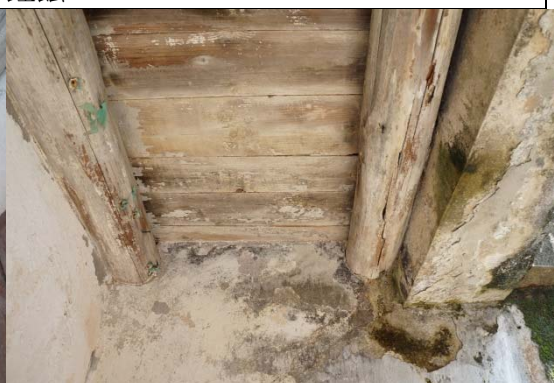
照片 28 前迴向一樓騎樓次間樑外部白蟻嚴重蛀蝕、內部局部損壞
