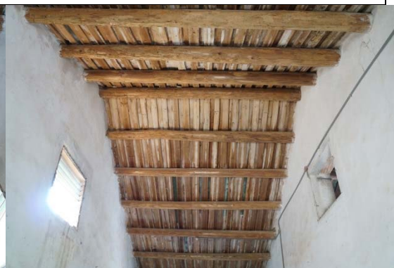
照片 22 主棟二樓次間房樑嚴重損壞
