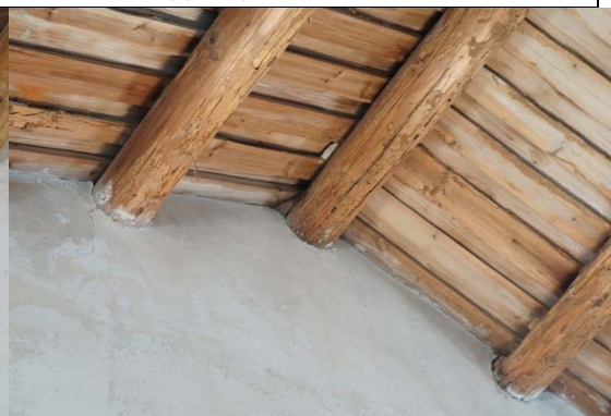
照片 24 主棟二樓次間房樑白蟻蛀蝕嚴重
