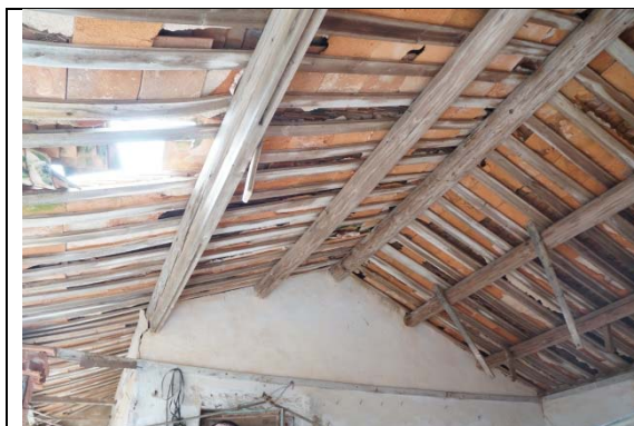
照片 41 前迴向二樓明間樑屋桁內部白蟻蛀蝕
