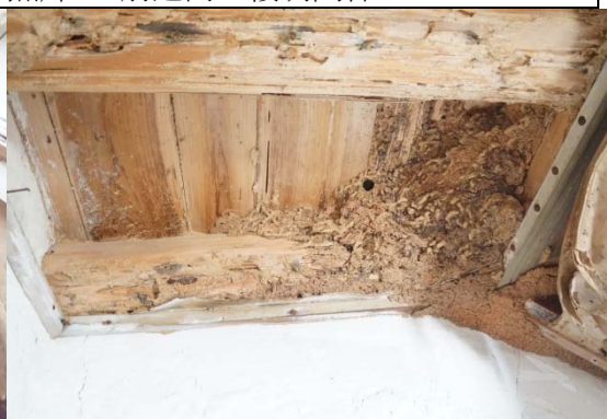
照片 32 前迴向一樓明間樑嚴重白蟻蛀蝕
