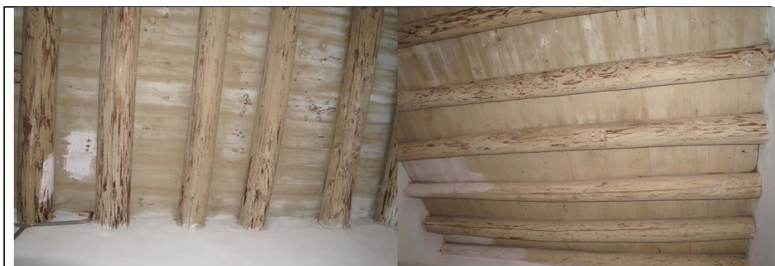
照片 9 主棟一樓次間後房樑局部損壞
