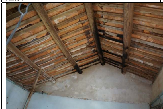
照片 43 前迴向二樓次間樑曾被火燒
