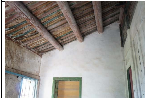
照片 19 主棟二樓明間後廳樑嚴重損壞
