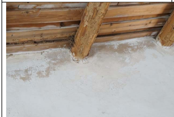
照片 23 主棟二樓次間房樑白蟻蛀蝕嚴重
