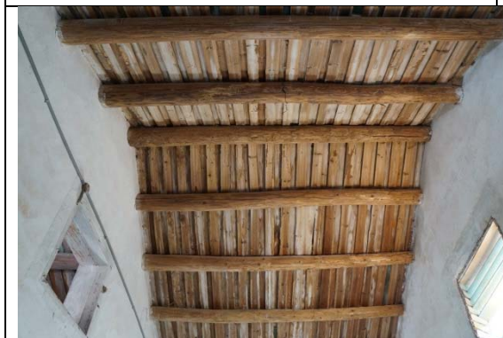
照片 21 主棟二樓次間房樑嚴重損壞
