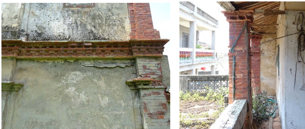
圖 42 主棟一樓前廊及前迴向二樓磚柱移外及牆面龜裂
