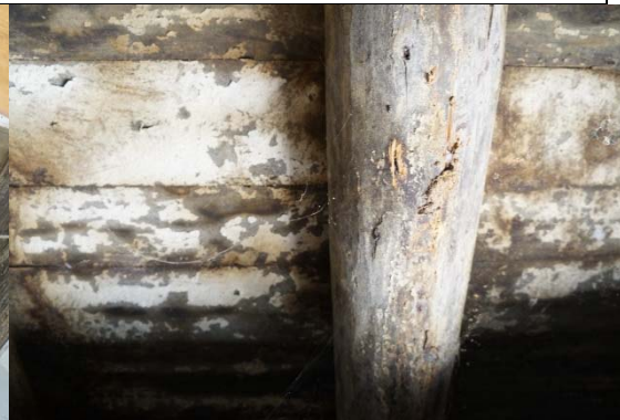
照片 36 前迴向一樓次間樑嚴重損壞
