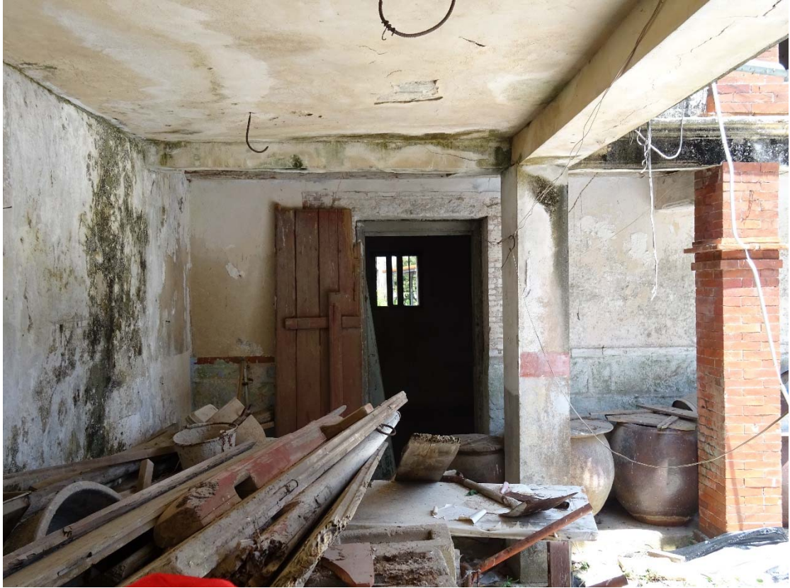
圖 43 主入口內加設外廊底面鋼筋外露生鏽脆化狀況
