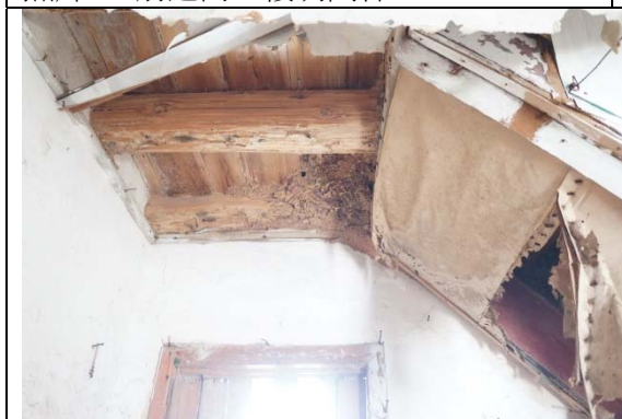
照片 31 前迴向一樓明間樑嚴重白蟻蛀蝕
