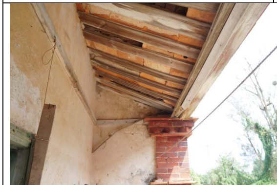
照片 39 前迴向二樓騎樓次間樑白蟻蛀蝕嚴重
