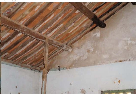
照片 44 前迴向二樓次間樑曾被火燒
