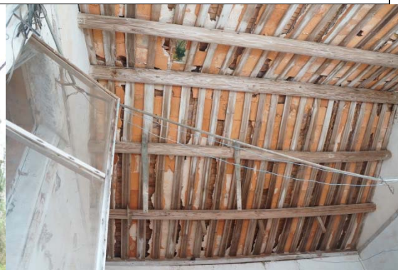
照片 40 前迴向二樓明間樑屋桁內部白蟻蛀蝕
