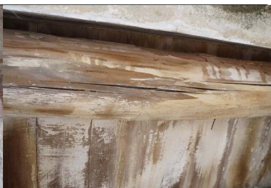
照片 26 前迴向一樓騎樓明間樑嚴重白蟻蛀蝕
