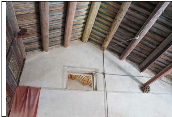
照片 17 主棟二樓明間廳樑局部損壞
