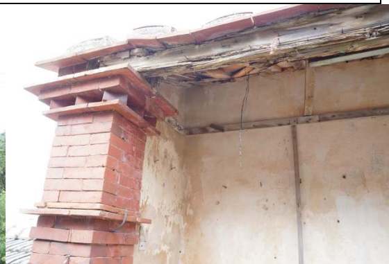
照片 38 前迴向二樓騎樓次間樑白蟻蛀蝕
