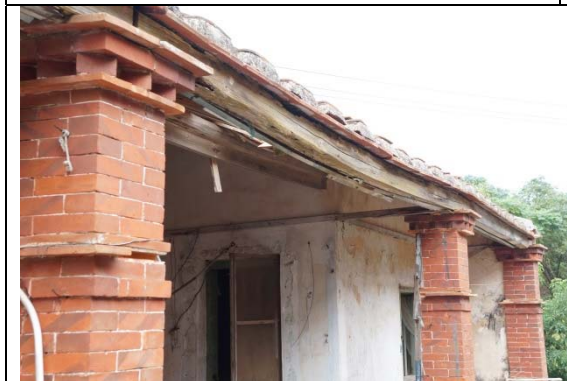
照片 37 前迴向二樓騎樓明間樑白蟻蛀蝕
