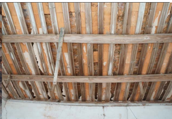
照片 42 前迴向二樓明間樑屋桁內部白蟻蛀蝕
