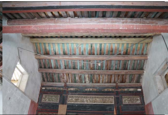
照片 18 主棟二樓明間廳樑局部損壞
