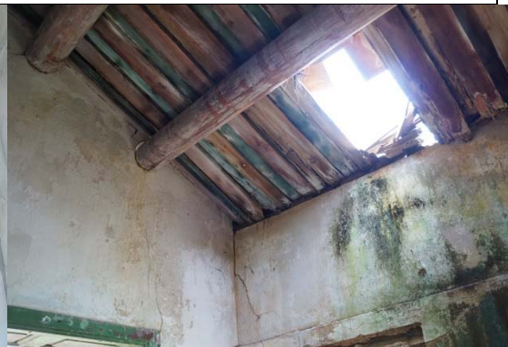
照片 20 主棟二樓明間廳樑嚴重損壞
