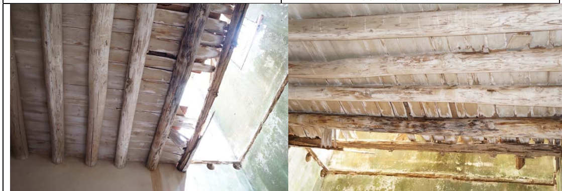
照片 13 主棟一樓次間房樑 部分局部損壞、部分嚴重損壞佚失
