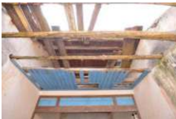
照片 4- 254 梯間屋頂與天花樓板崩塌
