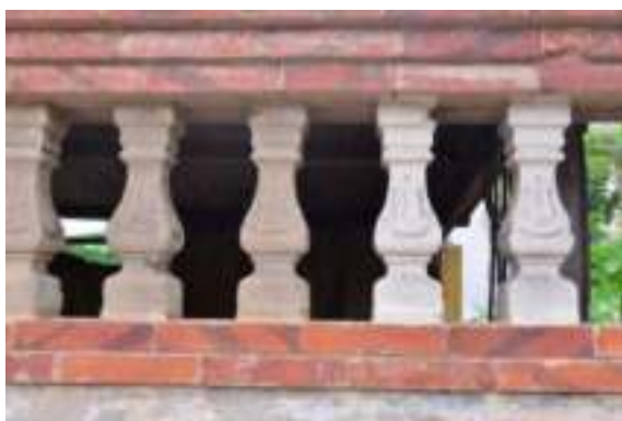
照片 4-46 方形花瓶欄杆部分損壞與替換品
