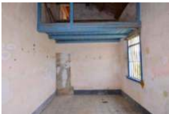
照片 4-279 右後房與半樓現況
