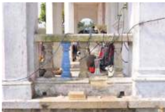
照片 4- 121 前廊左側扶手花瓶欄杆斷裂欄檻破損
