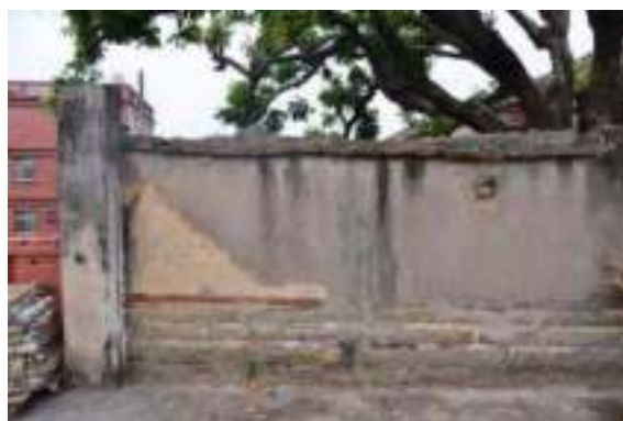
照片 4- 50 水池邊圍牆牆身多處破損與修補
