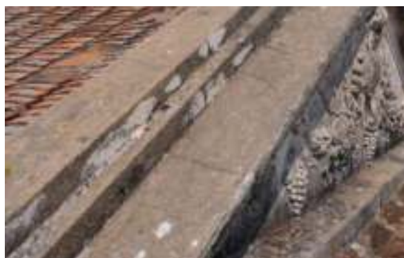
照片 4- 329 垂脊有多處裂隙產生
