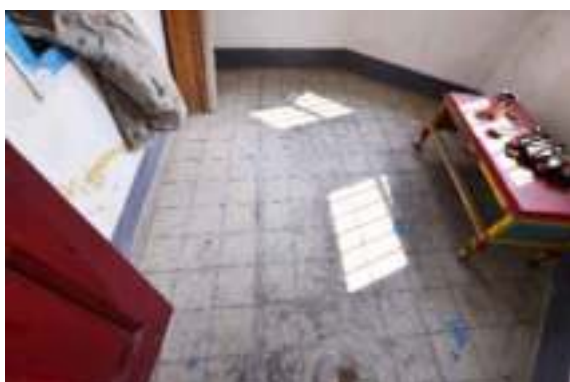
照片 4- 223 左塌岫房地坪
