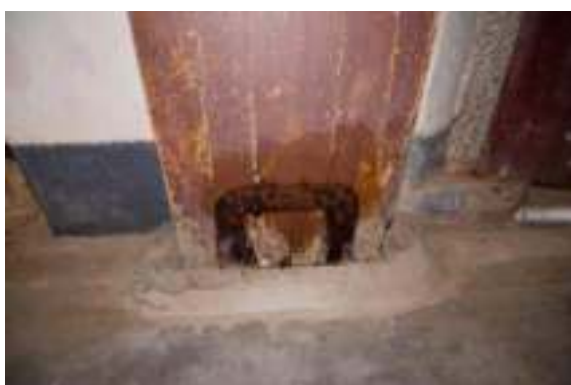
照片 4- 195 輪錢門下端及門槽被封起
