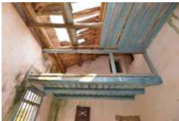
照片 4-277 右前房屋頂崩塌造成屋架與天花毀損
