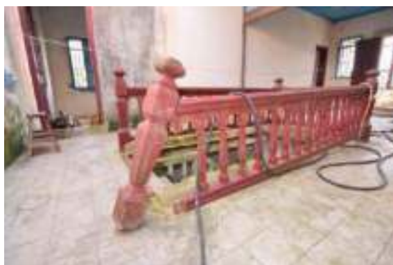
照片 4- 252 木作欄杆望柱損壞欄檻腐朽
