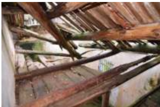
照片 4-586 右前房完全崩塌
