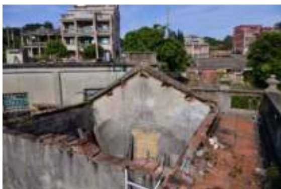
照片 4-412 左房屋頂崩塌與前廊屋頂
