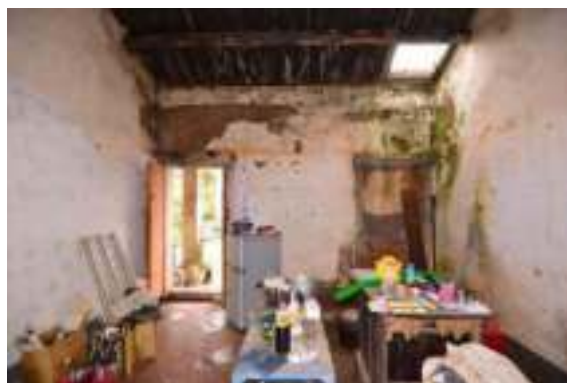
照片 4- 446 迴向明間左前天窗開口滲水
