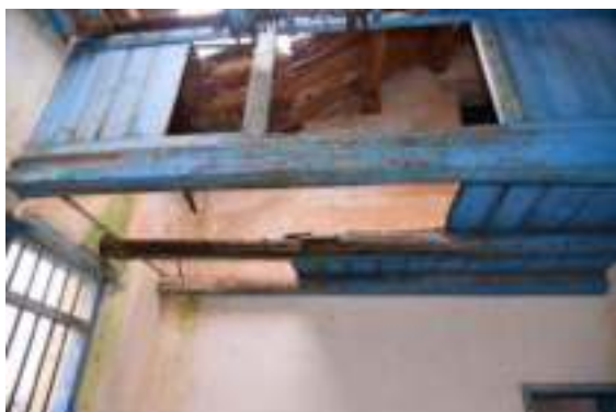
照片 4-574 左後房半樓嚴重毀損
