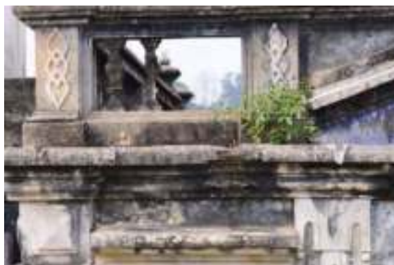
照片 4-355 左側廊牆檐口破損長榕樹
