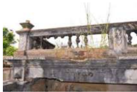
照片 4- 401 右側女兒牆欄杆破損嚴重檐口長草
