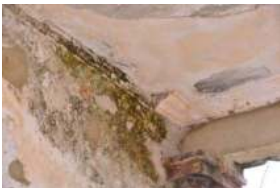
照片 4-473 RC 樓板損壞壁體滲水破壞
