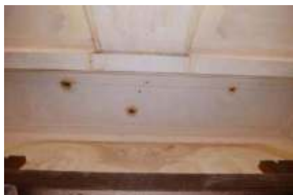
照片 4-190 輪錢門上方樓板開三孔
