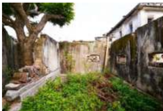
照片 4- 520 前房內部現況牆體崩塌
