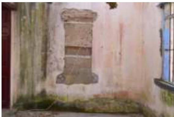
照片 4-287 右前房窗戶封閉壁體損壞
