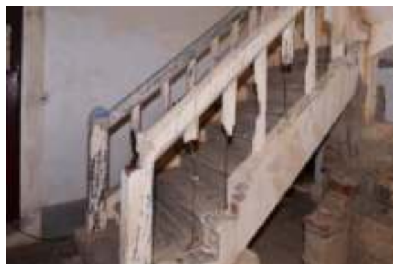
照片 4- 193 RC 樓梯欄杆嚴重爆裂損壞
