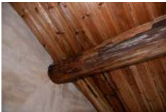
照片 4- 592 後一架端部腐朽嚴重
