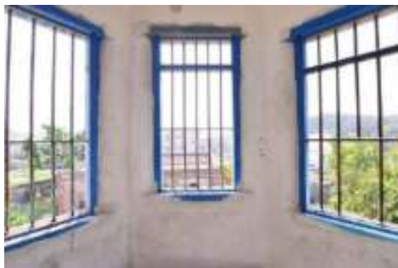
照片 4- 234 右塌岫房窗扇佚失
