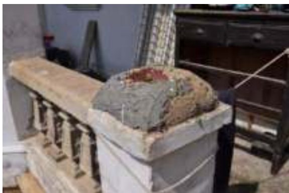
照片 4- 120 一樓臺階上方欄杆望柱損壞水泥塗抹
