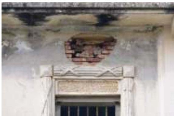
照片 4-147 左側大規壁牆體破損露出紅磚構造
