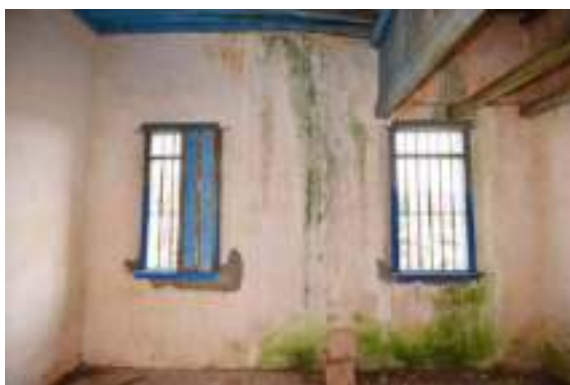
照片 4-265 屋頂崩塌窗扇佚失、牆壁髒污
