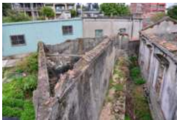
照片 4- 490 後房屋頂崩塌
