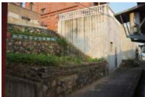
照片 2-57 後側層差約有一層樓高
