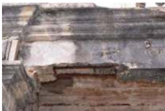
照片 4-397 右前廊 RC 樑鋼筋生鏽混凝土爆裂
