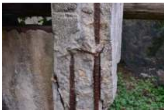
照片 4- 502 早期之 RC 立柱生鏽爆裂
