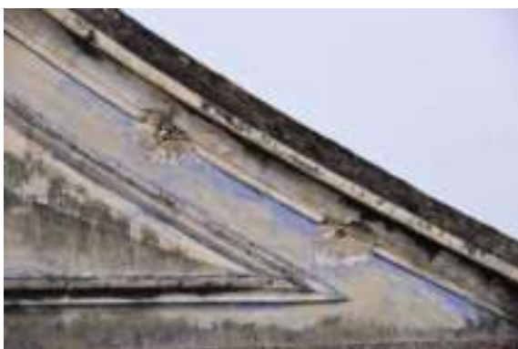
照片 4-358 左大規壁後檐板與檐口損壞
