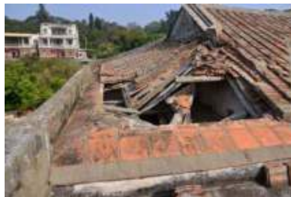
照片 4- 534 屋頂因木構件朽壞而破壞
