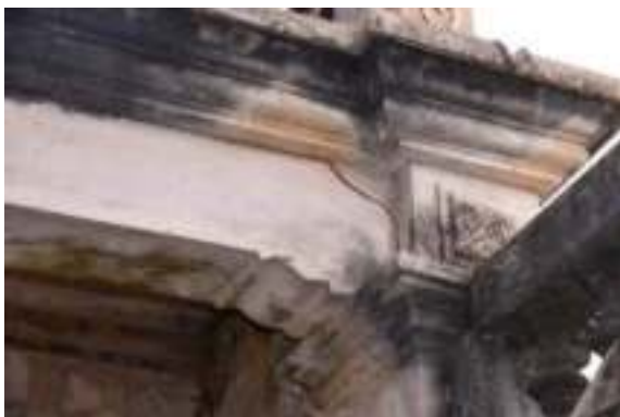
照片 4- 398 明間過廊交接處 RC 樑斜向裂縫
