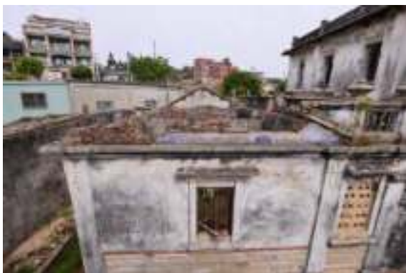
照片 4-352 右大規壁山尖崩塌
