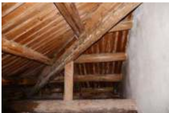
照片 4- 584 左前房上方屋架嚴重滲水腐朽
