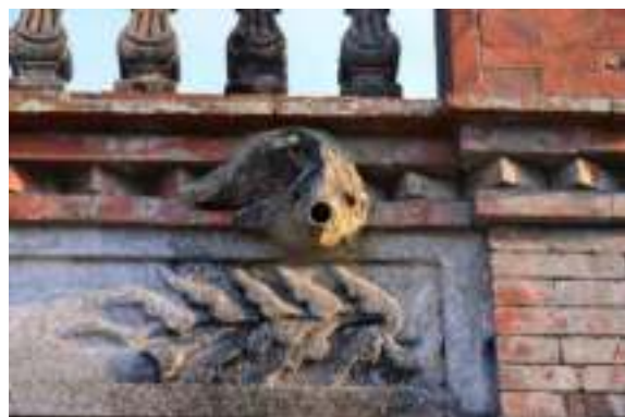
照片 3-50 迴向檐口鯉魚漏水口
