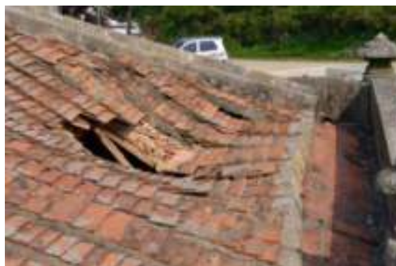
照片 4- 323 左後房屋頂局部崩塌
