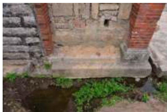
照片 4- 98 左側庭園排水不佳造成積水污染
