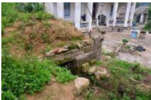
照片 4- 99 右側防空洞覆土等崩壞
