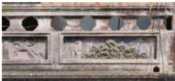
照片 4- 114 二樓鑄鐵窗下欄板泥塑左側
