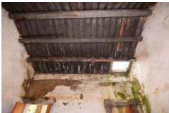
照片 4-477 明間屋架蛀蝕壁面損壞嚴重
