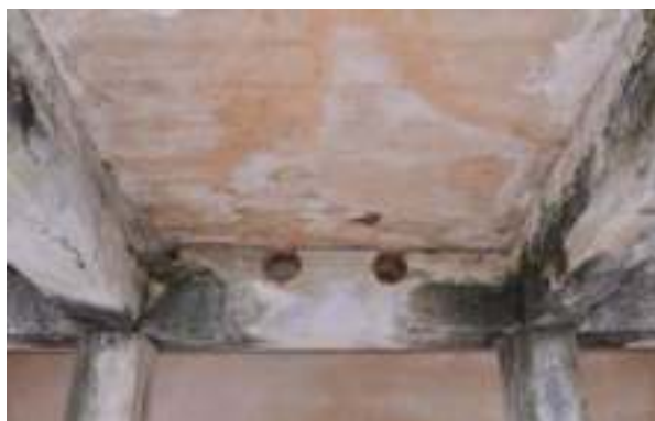
照片 4- 541 混凝土表面青苔造成劣化與鋼筋生鏽
