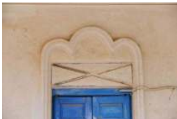
照片 4-174 窗楣及上方壁體有輕微風化損壞
