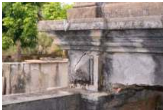
照片 4- 544 柱樑節點之剪力破壞
