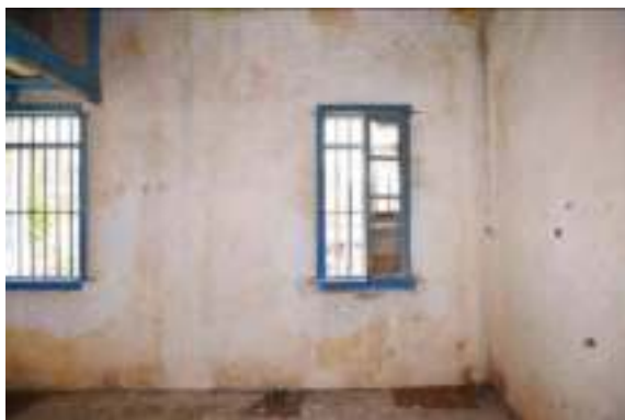
照片 4- 259 左前房左側開窗窗扇均佚失壁體水漬
