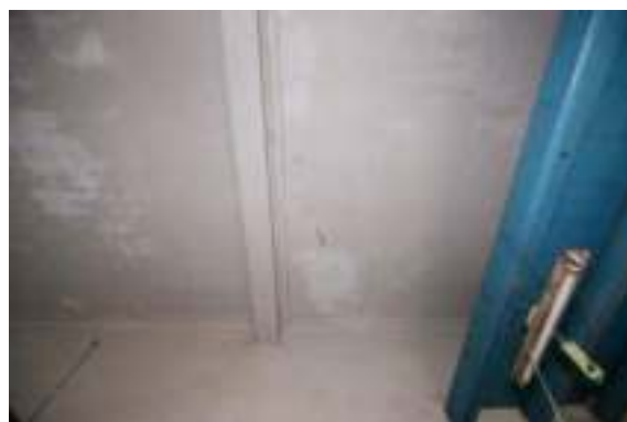
照片 4- 200 右前房 RC 天花樓板與 RC 小樑
