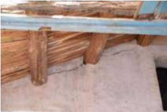
照片 4- 550 屋樑固定處之斜裂縫
