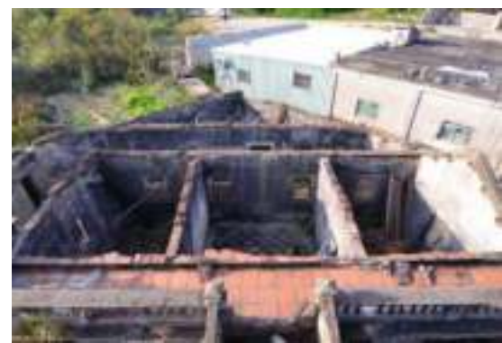
照片 4- 571 後棟與其後之後房屋頂全數崩塌
