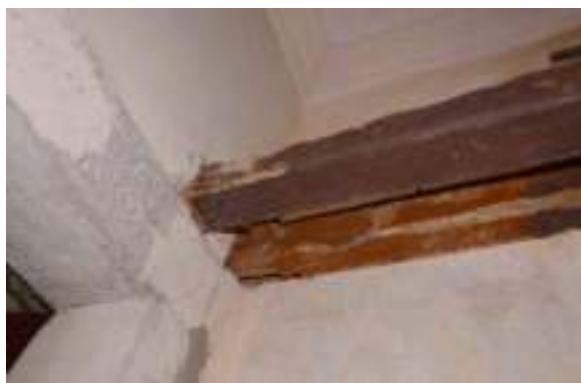
照片 4- 535 白蟻柱蝕
