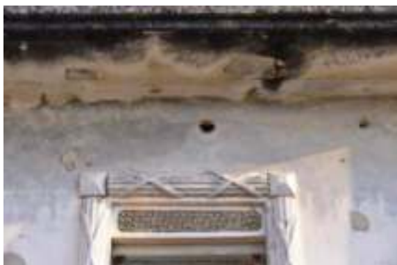
照片 4-149 二樓挑檐鋼筋生鏽破損
