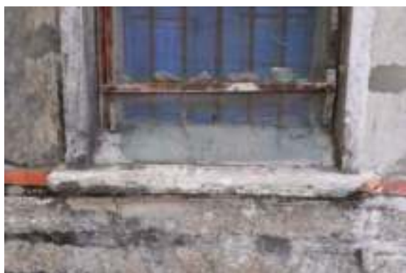
照片 4-485 鐵窗生鏽窗臺損壞
