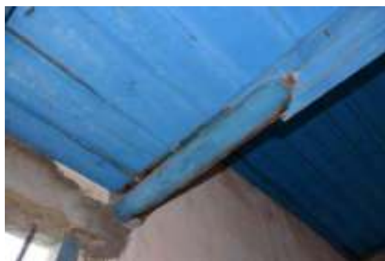
照片 4-579 右後房 E6 木樑嚴重蛀蝕損壞
