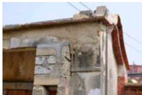
照片 4-76 後坡檐口捧錢樑與墀頭損壞
