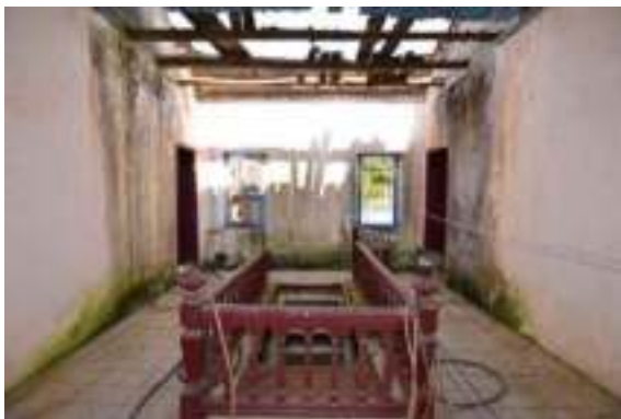
照片 4- 531 木天花板與木樑蛀朽現況
