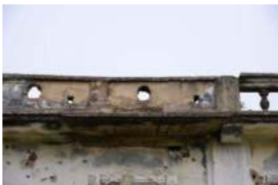
照片 4-159 右側女兒牆曾因砲宣彈毀損修補
