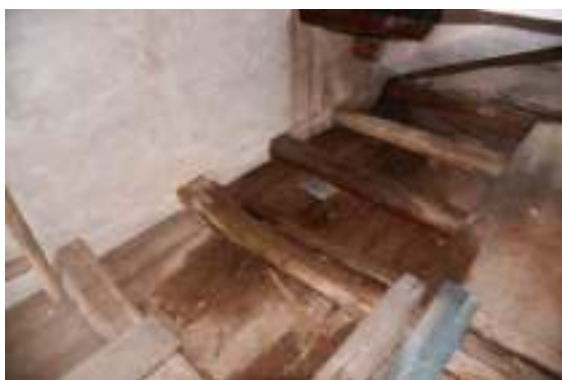
照片 4- 580 樓板木樑 F1-F4 左端嚴重滲水腐朽
