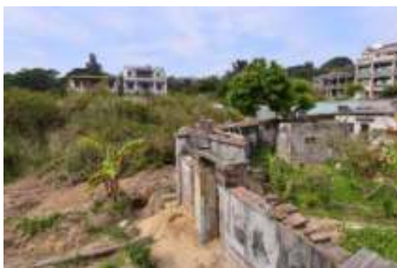
照片 4- 52 右後側圍牆牆頂多處損壞
