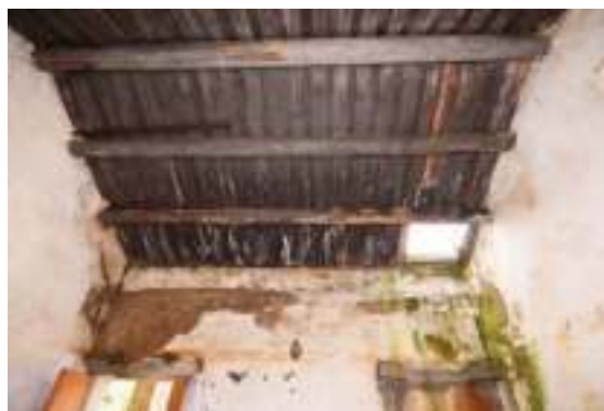
照片 4-595 明間屋架均嚴重蛀蝕
