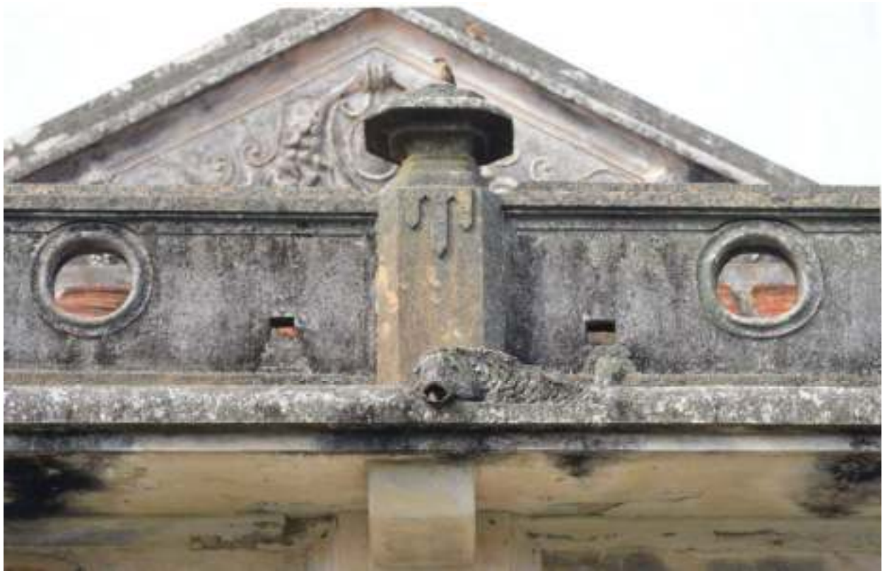
屋頂女兒牆及簷口泥塑漏水口
