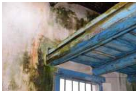
照片 4-576 右前房 E1 木樑損壞嚴重
