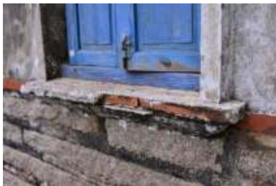
照片 4-484 窗臺損壞
