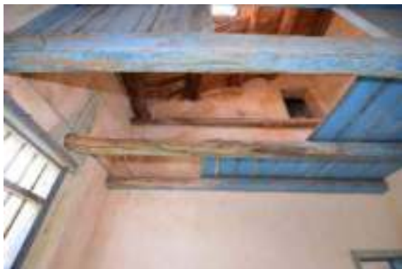
照片 4-271 左後房半樓樓板嚴重損壞
