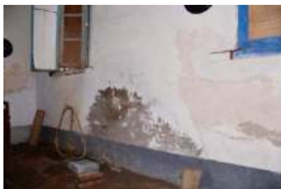
照片 4- 549 地坪積水，牆體因潮氣劣化
