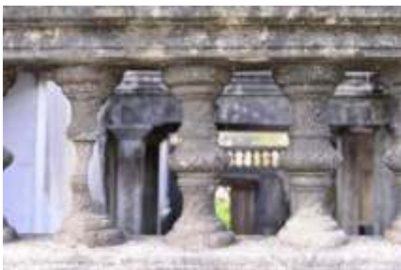
照片 4-354 左深井側牆花瓶欄杆損壞
