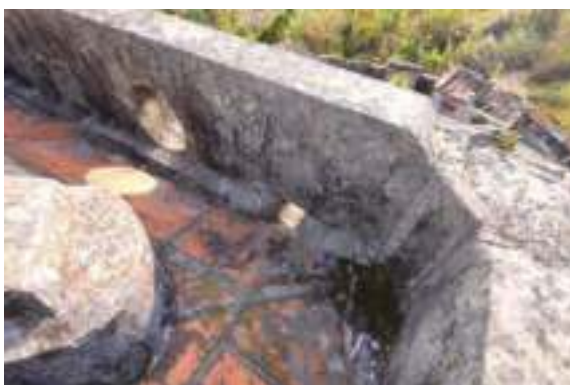
照片 4-316 尺磚檐口與女兒牆、漏水口
