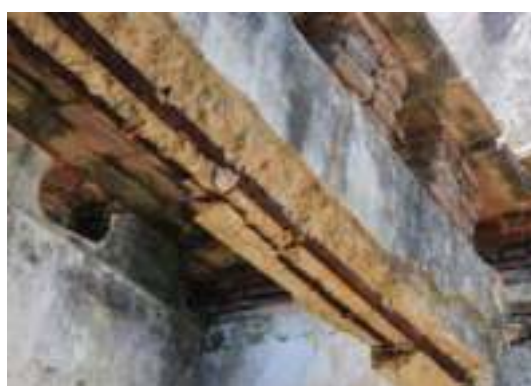
照片 3- 36 陳詩吟洋樓出龜 RC 樑下方之方形鋼筋
