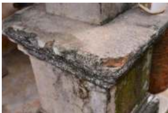
照片 4-394 前廊柱基磚作拖盤損傷
