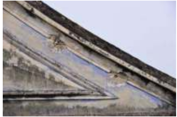
照片 4- 551 牆體外部於屋樑固定處之斜裂縫
