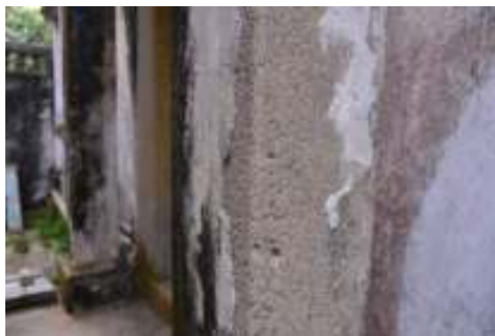
照片 4-377 過廊前柱柱身抹灰損壞
