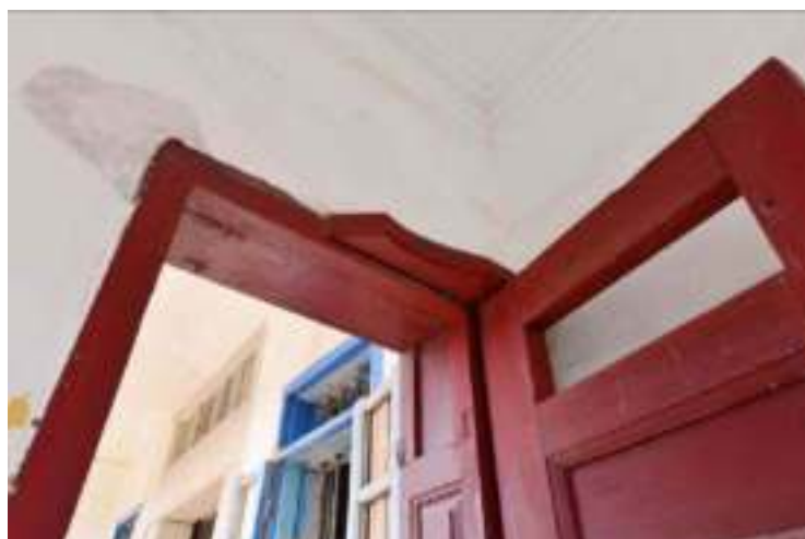
照片 4- 220 二樓左塌岫房門
