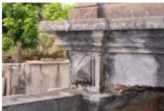
照片 4-395 右側邊柱柱頂破損開裂
