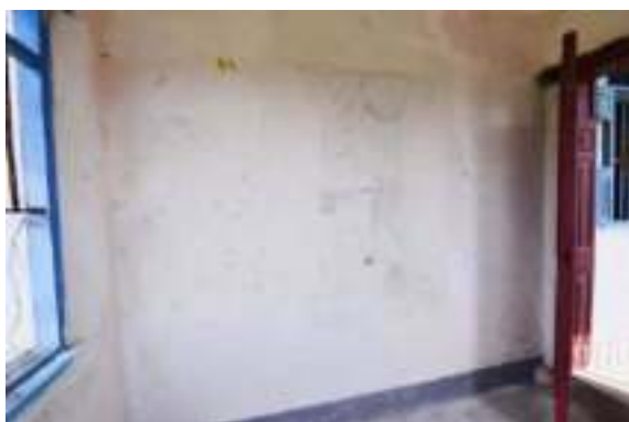
照片 4- 225 二樓右塌岫房
