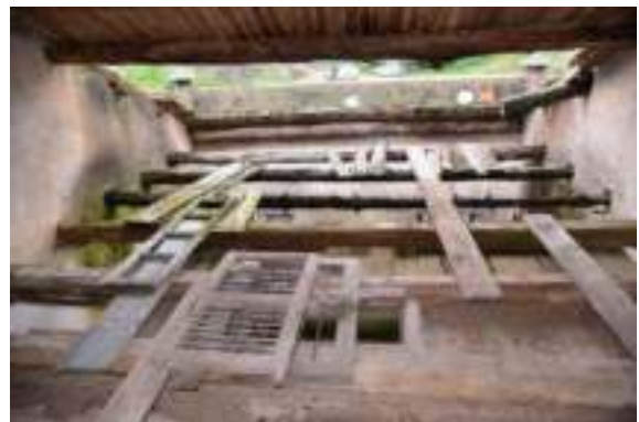
照片 4- 532 木天花板與木樑蛀朽現況
