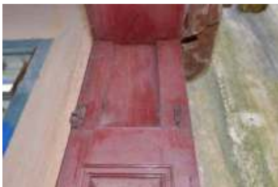
照片 4-291 右前房門框構件被鋸斷
