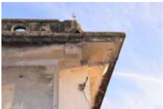
照片 4-151 右後邊柱柱頭有破裂損壞
