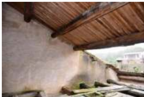
照片 4- 593 後坡屋架樑仔均嚴重腐朽
