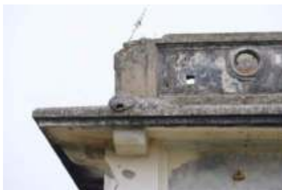
照片 4-160 右後女兒牆望柱柱頂破損
