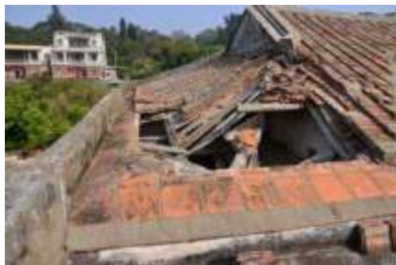
照片 4- 321 右前房屋頂崩塌
