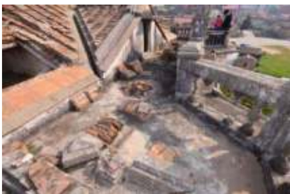
照片 4- 324 前廊 RC 平頂堆置散落之屋頂構件
