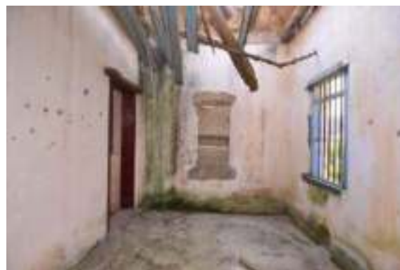
照片 4- 536 木天花板與木樑蛀朽現況
