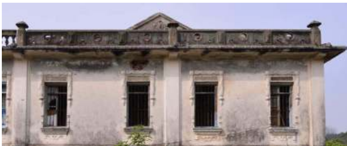
照片 4- 537 混凝土表面青苔造成劣化
