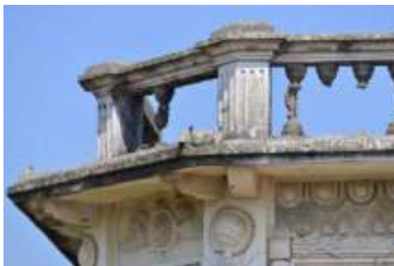
照片 4- 127 右屋頂挑檐樑生鏽及花瓶欄杆斷裂
