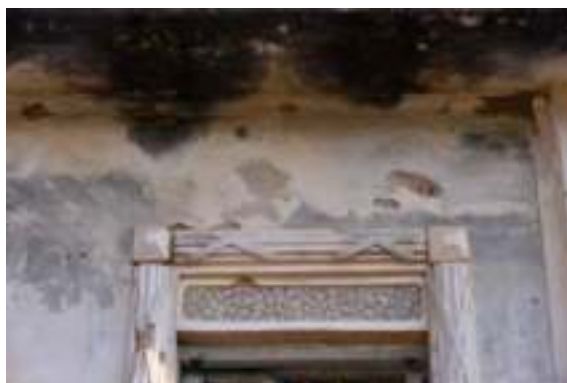
照片 4-150 二樓窗戶楣樑上壁體局部破損
