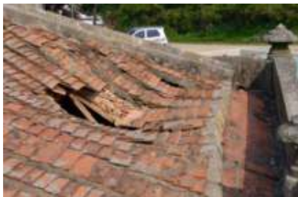
照片 4- 533 屋頂因木構件朽壞而破壞
