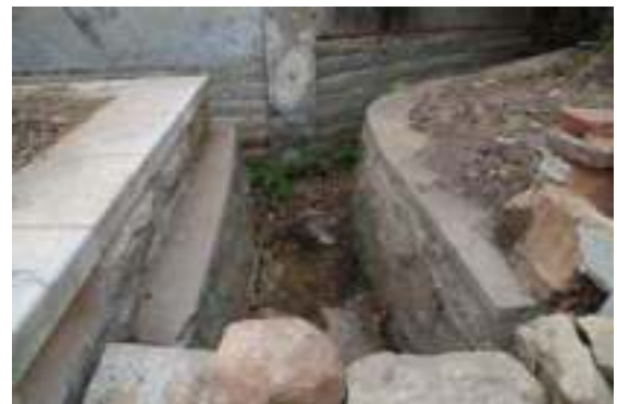
照片 2- 118 水源沿著董允耀洋樓的外圍逕流
