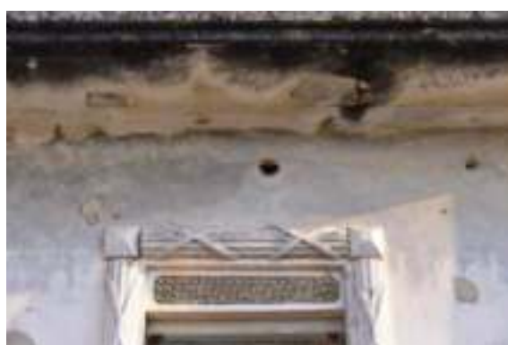
照片 4- 539 混凝土表面青苔造成劣化與鋼筋生鏽
