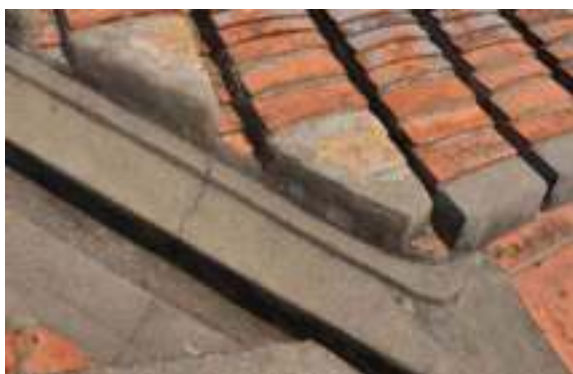
照片 4- 328 天溝有裂隙產生
