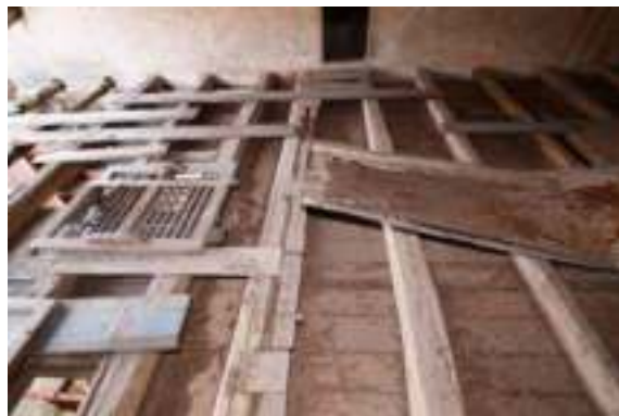
照片 4-304 大廳上方木樓板損壞現況
