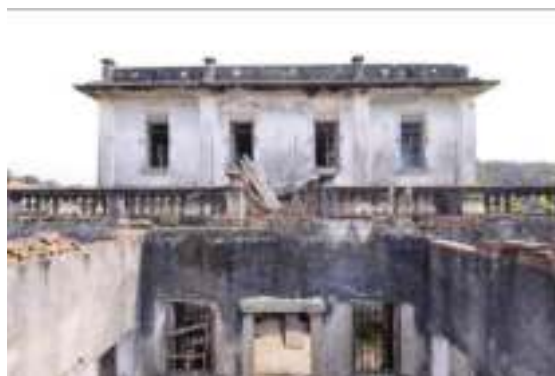
照片 4-419 後棟明間屋頂崩塌
