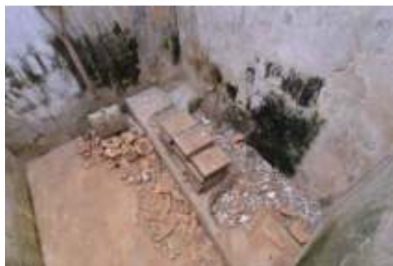
照片 4- 510 廁所內部部分已封閉
