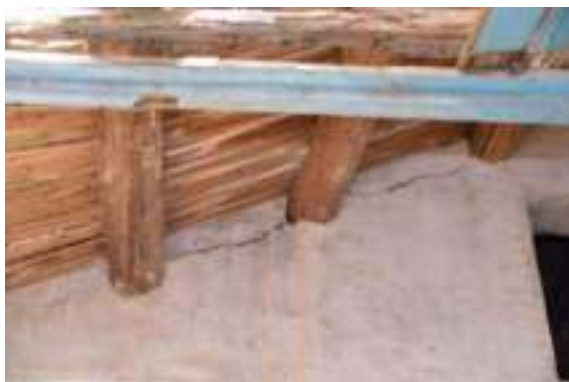
照片 4-289 右前後房承重牆端開裂
