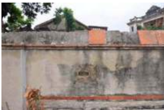
照片 4- 49 圍牆中之槍口，牆頂尺磚掉落與破損
