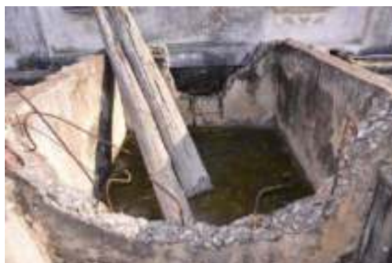
照片 4- 543 RC 水塔劣化破損，鋼筋生鏽
