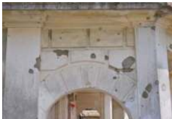
照片 4- 125 右拱圈上方拱壁多處修補痕跡
