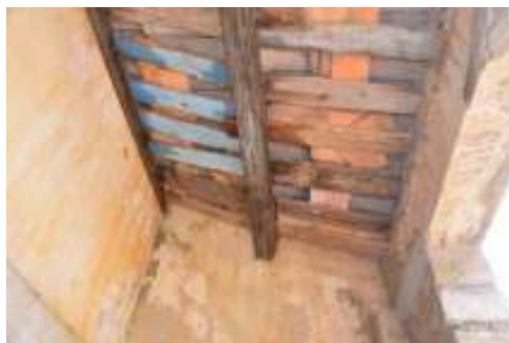
照片 4-74 後坡屋架損壞嚴重
