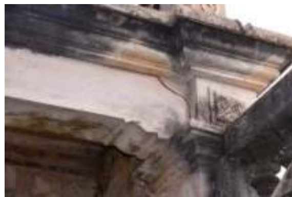
照片 4- 545 樑端剪力破壞
