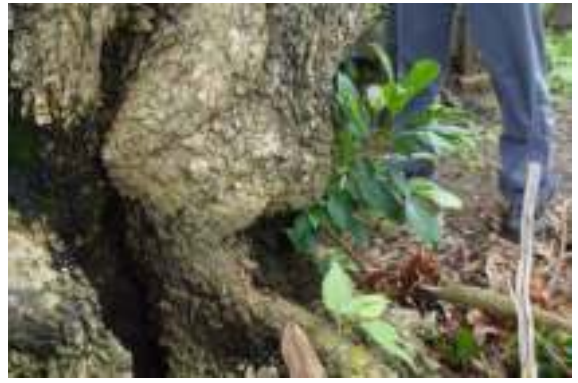
照片 4-28 榕樹寄生於幹腐朽處
