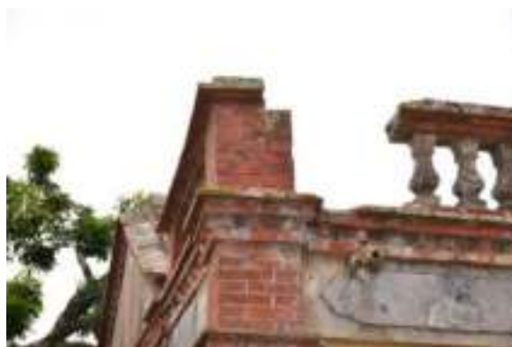
照片 4-486 女兒牆毀損望柱傾斜
