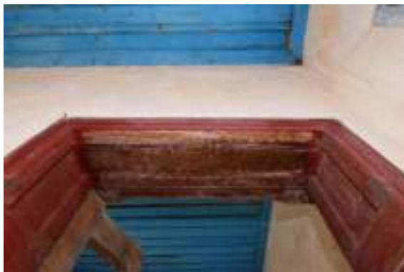
照片 4-272 左後房右房門門框損壞
