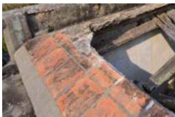
照片 4- 325 檐口尺磚未損壞
