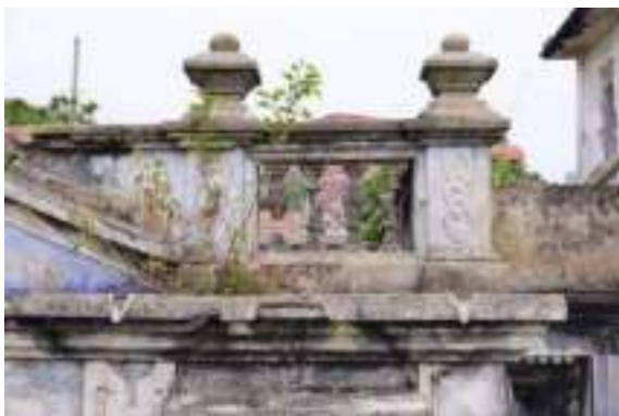
照片 4-356 右廊牆檐口破損長雜木破壞
