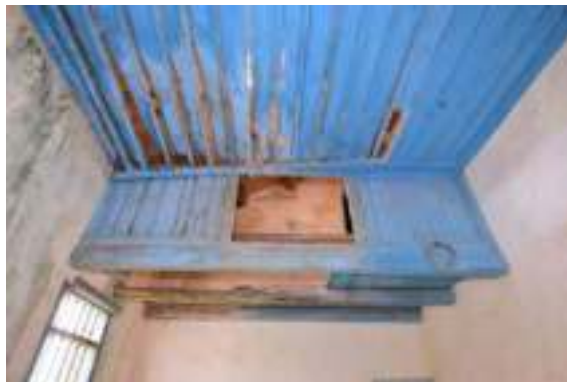
照片 4-270 左後半樓嚴重破壞
