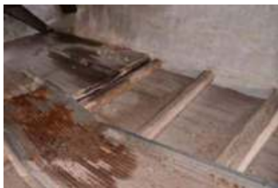
照片 4- 581 樓板木樑 F1-F4 右端滲水腐朽
