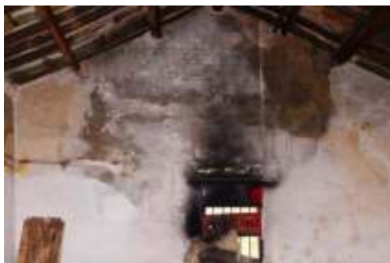
照片 4-480 左房壁面污漬嚴重
