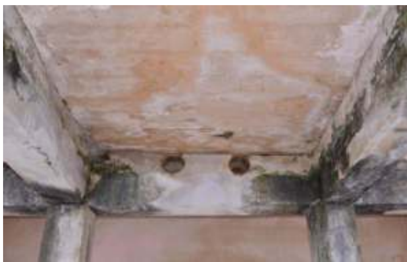
照片 4- 369 原木樑仔孔洞、RC 樑及後期改作 RC 樓板
