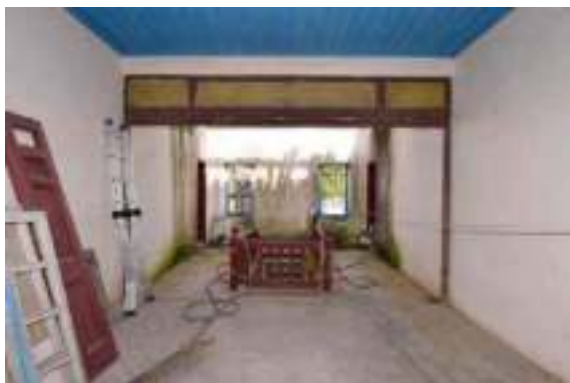
照片 4- 235 二樓大廳壽屏佚失
