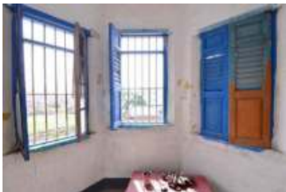
照片 4- 233 左塌岫房窗扇佚失
