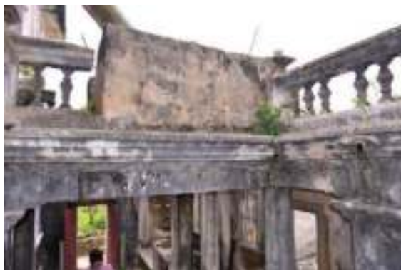
照片 4-378 增設之水塔損壞原欄杆扶手
