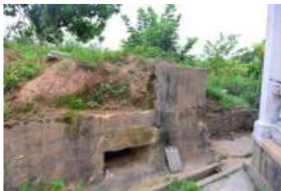
照片 4- 524 防空洞覆土被挖掘
