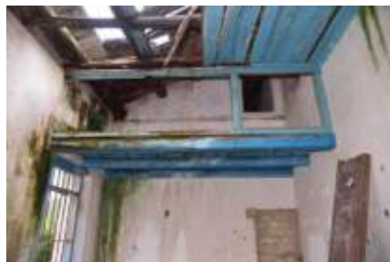
照片 4-575 右前房屋頂崩塌半樓部分毀損
