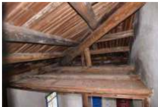
照片 4-587 右後房多數構件蛀蝕腐朽
