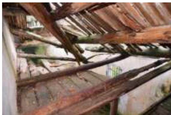
照片 4-302 右前房屋架及半樓毀損
