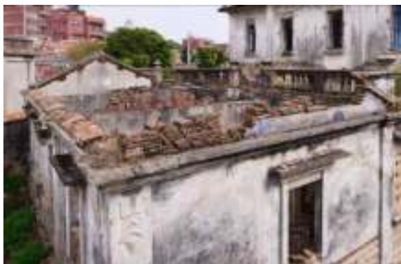
照片 4-402 後棟屋頂與山牆崩塌現況
