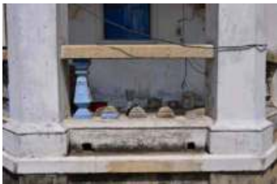
照片 4- 122 左次間前欄杆斷裂
