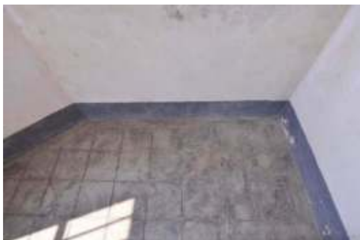
照片 4- 228 右塌岫房地坪
