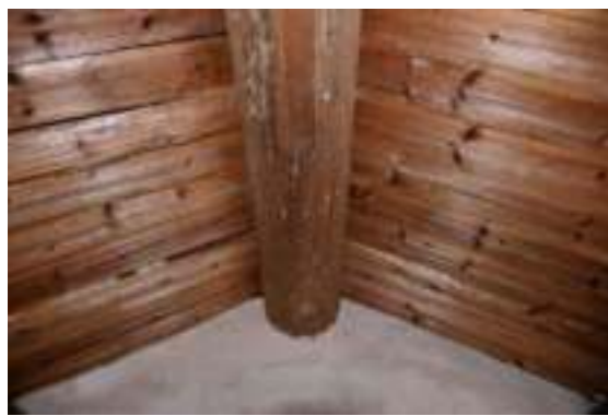
照片 4-591 中脊內部蛀蝕嚴重
