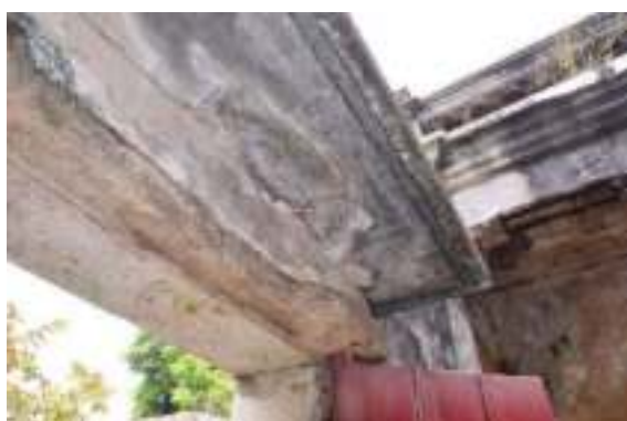
照片 4- 542 雨庇混凝土劣化
