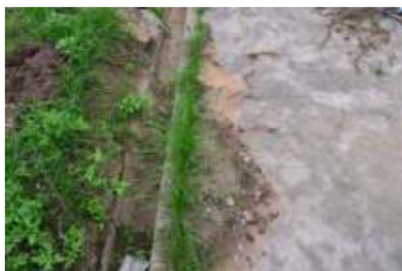
照片 4- 96 右次間地坪破損
