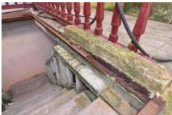
照片 4- 253 樓梯鑄鐵拉門損壞嚴重
