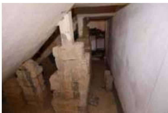
照片 4- 194 樓梯下方之後期隨意砌之磚柱
