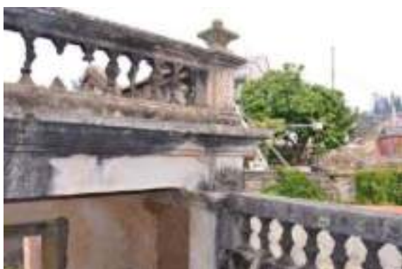
照片 4- 400 左側女兒牆欄杆破損嚴重
