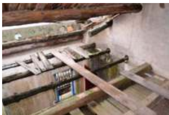
照片 4- 583 樓板木樑 F10-F14 嚴重腐朽損壞
