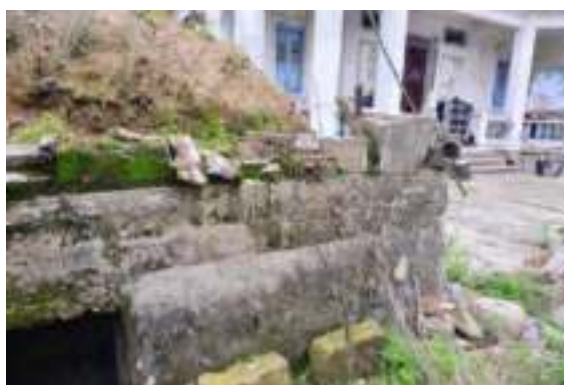
照片 4- 526 防空洞構造風化損壞
