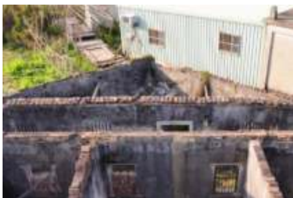
照片 4- 489 後棟與後房屋頂完全崩塌
