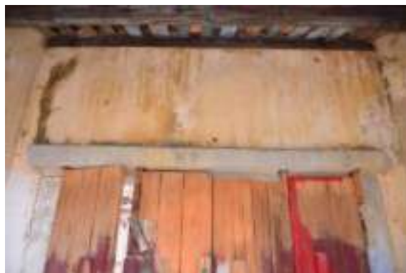
照片 4-72 大門背牆頂水漬等損傷
