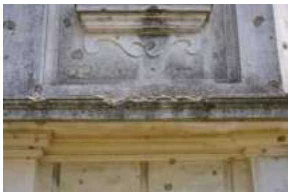
照片 4- 126 右拱圈上方檐口破損與修補
