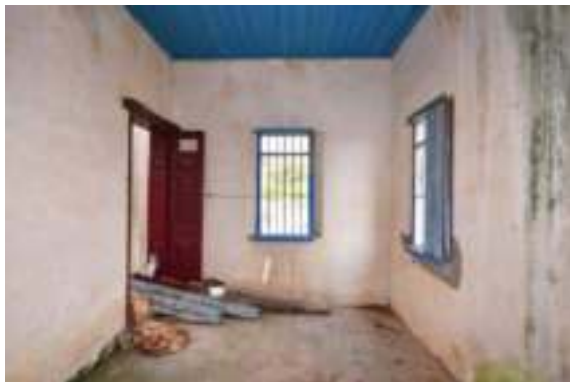
照片 4-269 左後房壁體污漬嚴重
