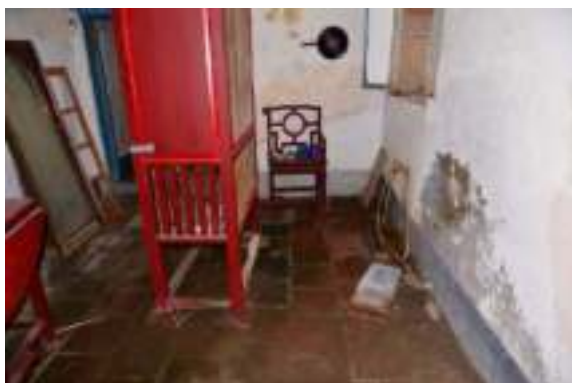
照片 4-209 右後房地坪潮濕積水
