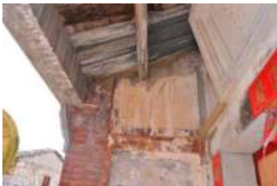
照片 4-71 廊牆上方壁體嚴重剝落與屋架損壞
