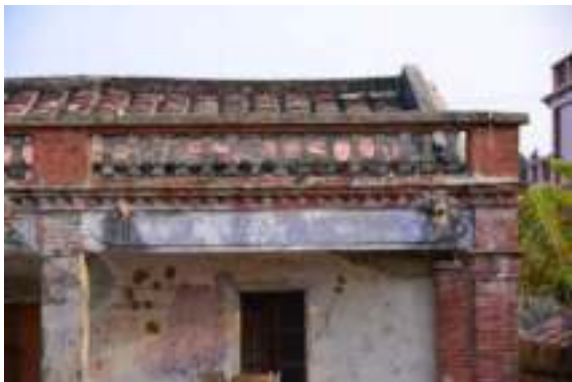
照片 4-431 前廊正面左檐口與女兒牆
