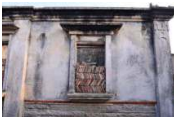
照片 4-353 後寮牆窗戶封閉、牆身污損
