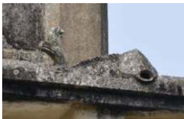
照片 4-146 右側女兒牆之鯉魚漏水口
