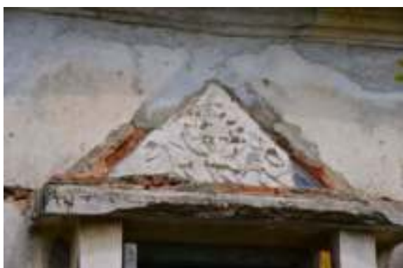
照片 4-155 一樓右後房後窗窗楣損壞
