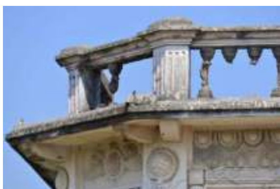
照片 4- 538 欄杆鋼筋混凝土劣化情形
