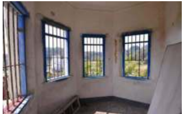
二樓右塌岫房
