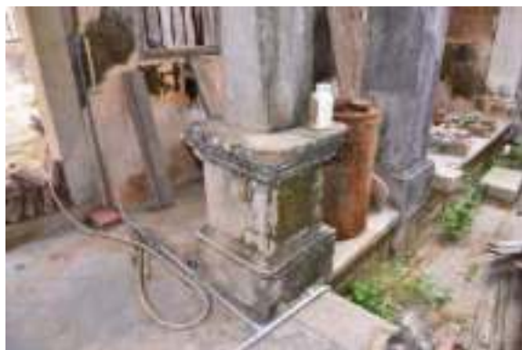
照片 4- 387 明間前方左側柱基與後期改作柱身
