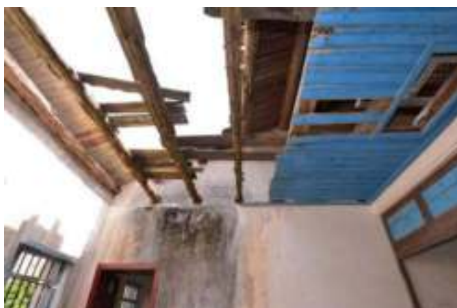
照片 4- 255 梯間上方屋頂與樓板崩塌
