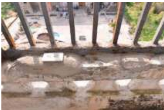
照片 4-231 鐵窗生鏽及欄檻不當補修
