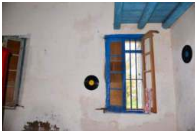
照片 4- 208 洋樓主棟一樓窗扇多佚失或改裝
