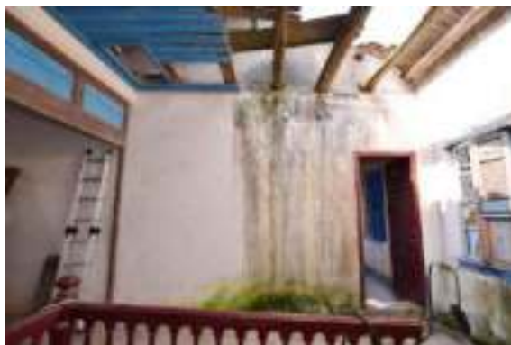
照片 4-248 梯間右側牆體與崩塌之屋頂
