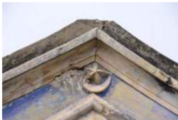
照片 4-357 左側脊墜檐板損壞、藍漆褪色脫落
