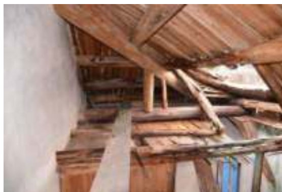
照片 4- 585 左後房屋架崩塌
