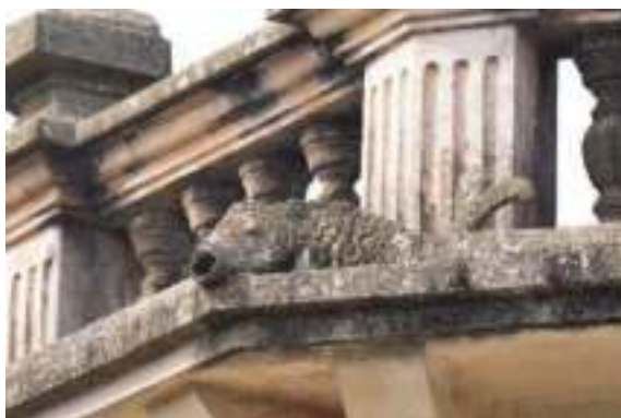
照片 3-49 檐口鯉魚漏水口
