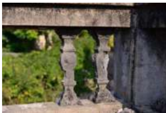
照片 4-423 花瓶欄杆斷裂
