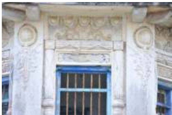
照片 4- 546 柱子頂部水平裂縫
