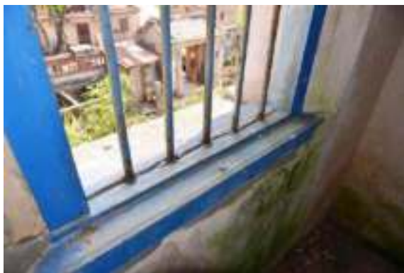
照片 4-273 左前房窗檻破損鐵窗生鏽
