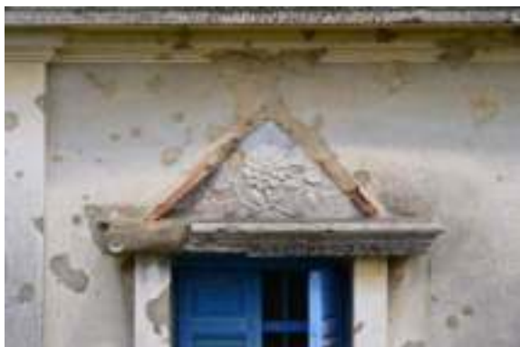
照片 4-153 一樓右前房後窗窗楣損壞
