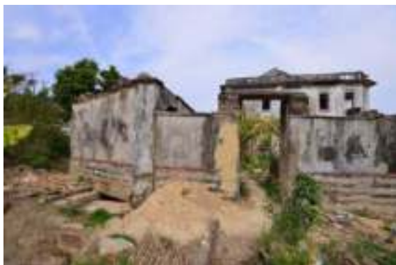
照片 4- 53 右後側圍牆開一門等後期破壞
