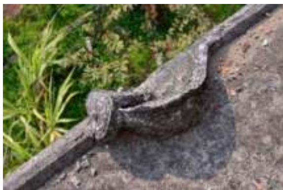
照片 4-313 檐口鯉魚泥塑漏水口
