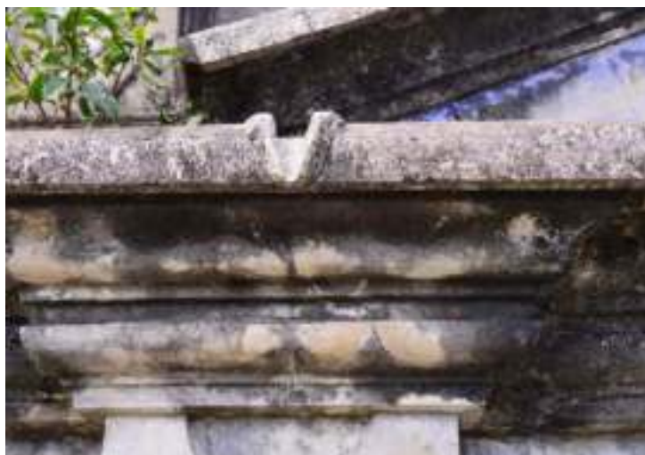
照片 4- 339 外挑檐口有凹凸之漏水口
