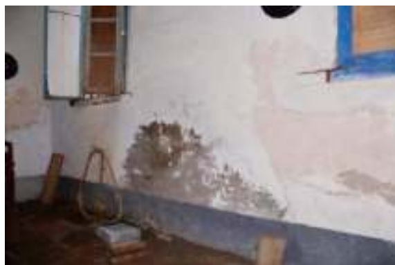
照片 4-210 右後房牆基潮氣影響而壁面損傷
