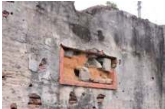
照片 4- 506 原開口封閉現況毀損
