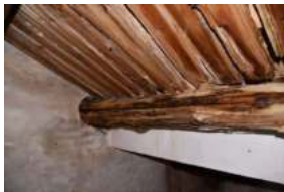
照片 4-590 前三架嚴重腐朽損壞
