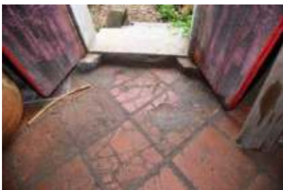
照片 4-475 明間地坪破損嚴重
