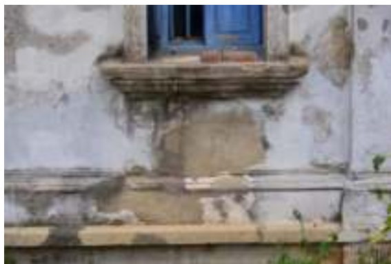
照片 4-152 右側一樓右前房前窗臺下方破損
