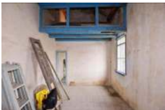
照片 4- 257 左前房現況
