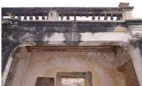
照片 4-396 RC 樑及檐口嚴重污損
