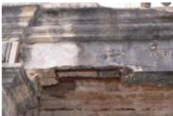
照片 4- 540 鋼筋生鏽造成混凝土表面剝落
