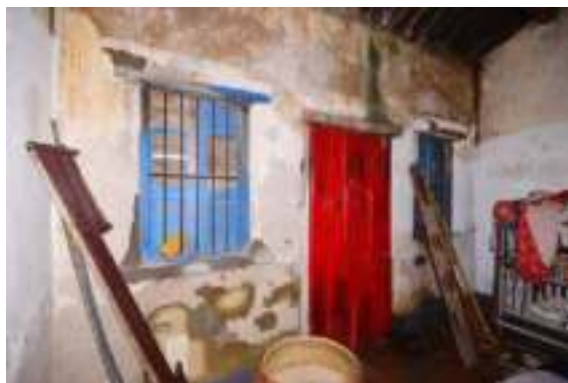
照片 4-478 明間後牆壁面污漬青苔嚴重
