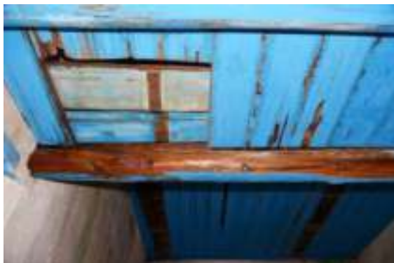
照片 4-572 左前房半樓 D1 木樑腐朽蛀蝕
