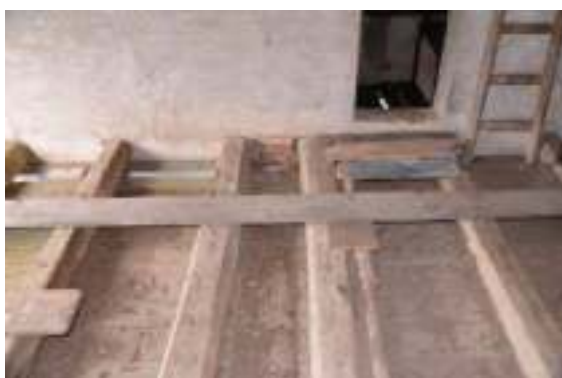
照片 4- 582 樓板木樑 F6-F9 均僅表面局部損傷
