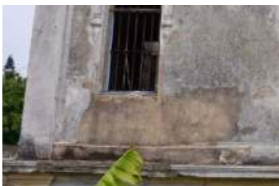
照片 4-157 二樓右後房窗臺與壁體損壞修補過
