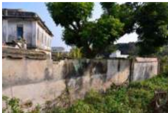
照片 4- 54 後側圍牆牆頂斷裂
