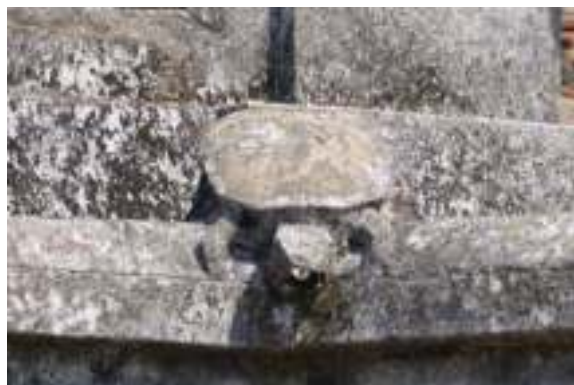
照片 3-48 檐口烏龜漏水口
