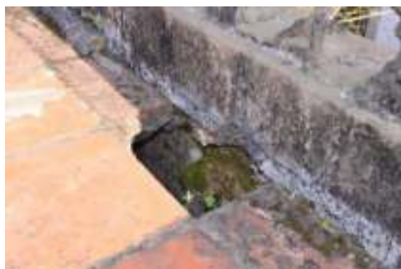
照片 4-422 前廊磚坪之砲彈破壞孔洞
