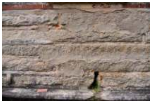
照片 4- 351 勾縫填補不佳造成損傷
