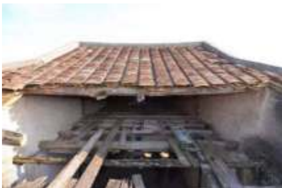
照片 4- 320 龜殼式屋頂後坡崩塌一半
