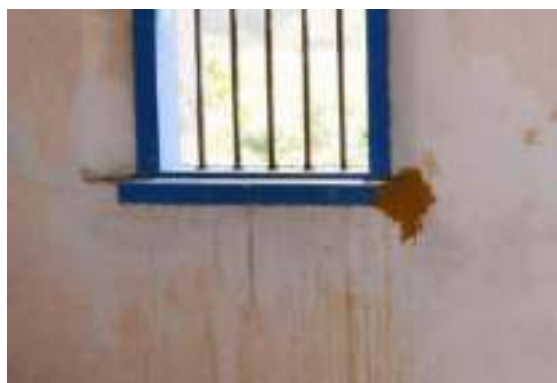
照片 4-294 右後房窗框與壁體受損
