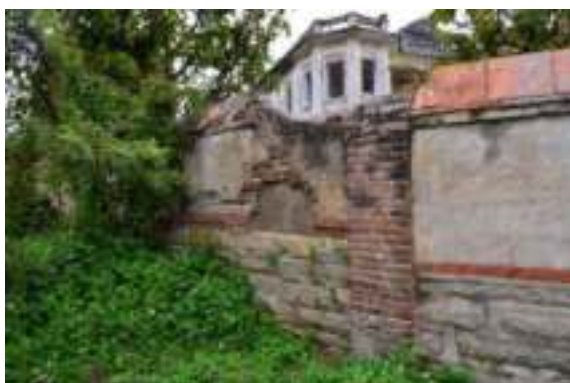
照片 4- 51 右側圍牆多處損壞修補與紅磚外露
