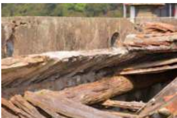
照片 4- 326 屋頂崩塌但檐口尺磚未崩塌
