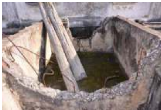
照片 4-379 破損之水塔
