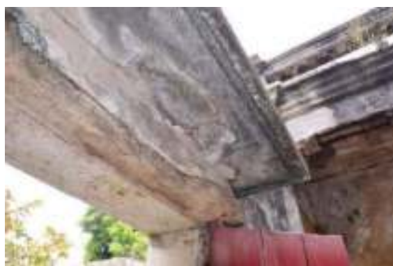
照片 4- 375 右側門後側門楣雨庇破損
