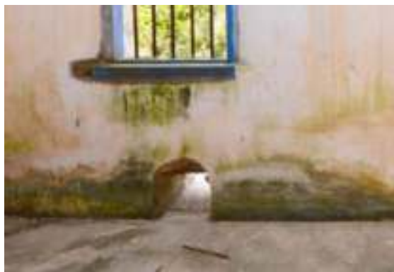
照片 4-288 右前房牆體鑿穿排水、壁體損傷
