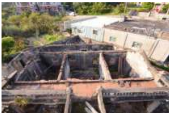
照片 4-418 後棟屋頂全數崩塌
