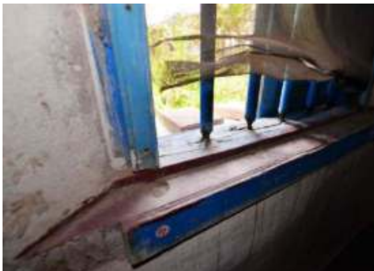
照片 4- 211 鐵窗生鏽造成窗框局部破壞
