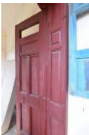
照片 4- 227 右塌岫房房門
