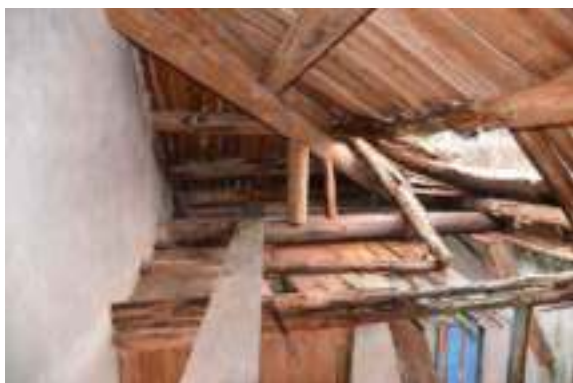
照片 4-301 左後房屋架及半樓毀損斷
