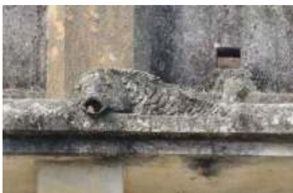
照片 4-145 左側女兒牆之鯉魚漏水口
