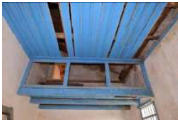
照片 4- 260 左前房半樓及天花板部分損壞
