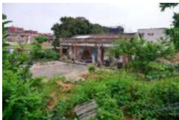
照片 4- 100 右側庭院雜草與雜木叢生
