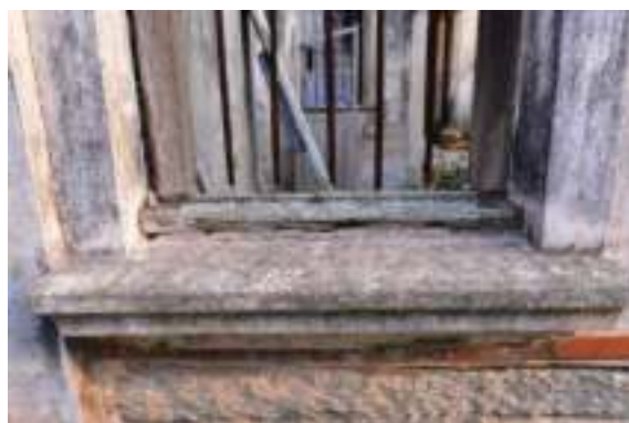
照片 4-359 鐵窗生鏽窗檻損壞嚴重
