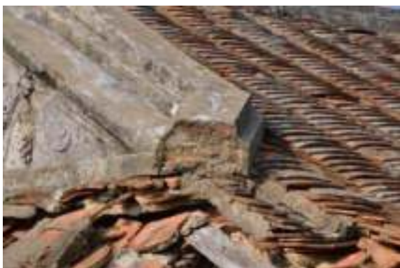
照片 4- 322 崩塌斷裂之垂脊與屋瓦
