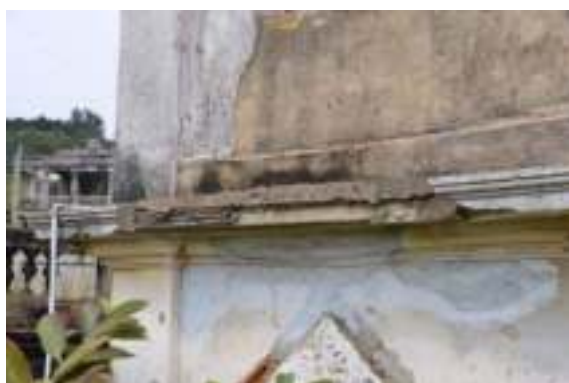
照片 4-158 二樓右後側檐口破損
