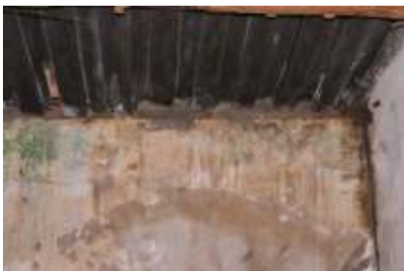
照片 4-479 牆體污漬青苔及修補痕
