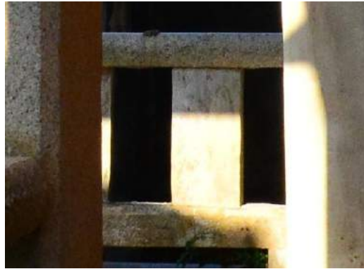
圖 187：部分需更換之欄杆
