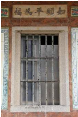
圖 119：一樓內層木窗與中層鐵窗（外層木窗已損壞）
