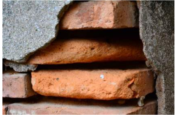
圖 196：後裙房屋身壁體剝落
