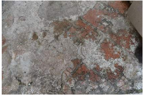
圖 168：左護龍入口鋪面水泥覆蓋情形
