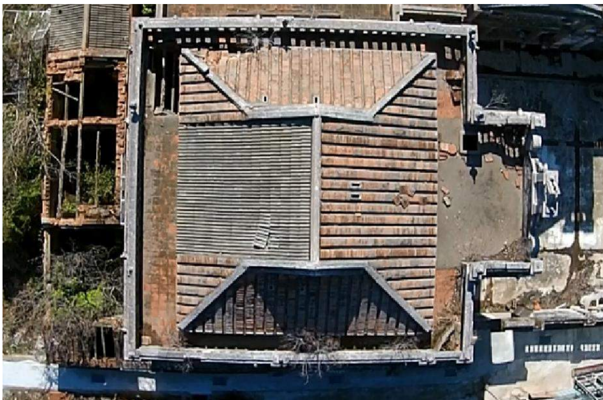
圖 199：王金城洋樓主體屋頂現況
