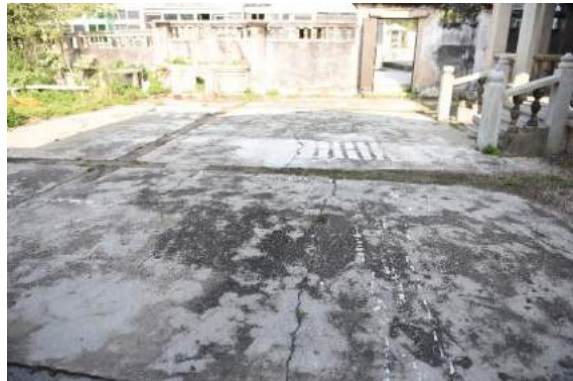
圖 158：王金城洋樓庭院水泥壓花現況
