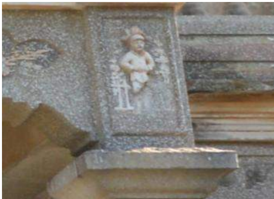
圖 208：正面泥塑裝飾部分破損
