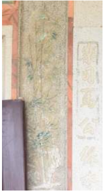
圖 206：泥塑竹葉部分毀損
