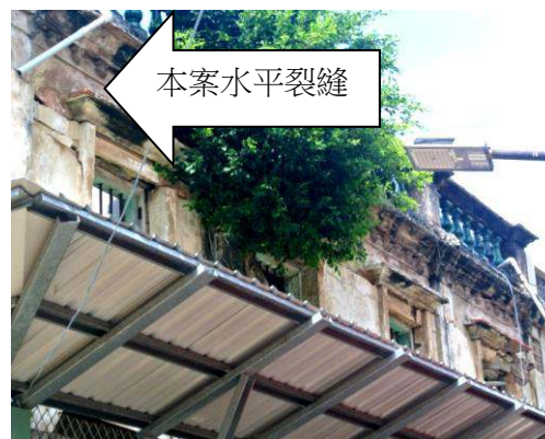
照片 3-3-10：二樓水平裂縫及植生
