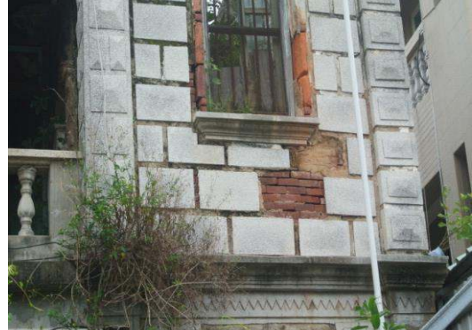
照片 3-3-14：正立面之面材剝落
