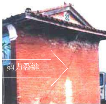
照片 3-3-8：磚牆之斜向剪力裂縫（引自：《文化資產保存學刊》，2014，第 28 期，頁 10）
