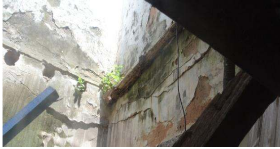
照片 3-3-25：右後房樓板塌落
