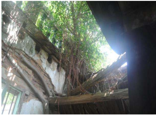
照片 3-3-31：右中房上方屋桁塌落、牆壁剝落及樹根盤繞
