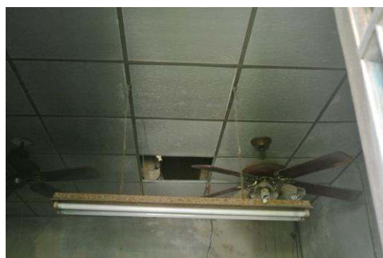
照片 3-3-23：前廳後期增天花板部掉落
