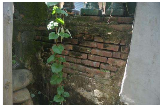
照片 3-3-42：圍牆內側粉刷層漿體剝落 及磚塊間灰漿劣化剝落
