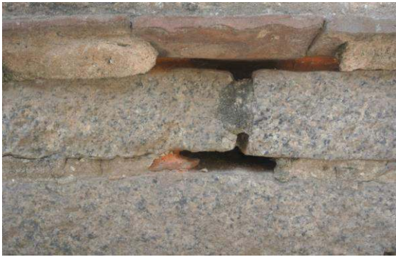
照片 3-3-13：一樓背面石材及磚材間灰縫材料劣化剝落
