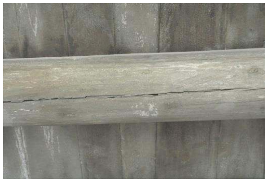
照片 3-3-18：桁木出現裂紋
