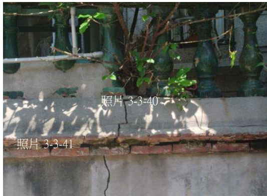
照片 3-3-39：圍牆上有雜樹及裂縫
