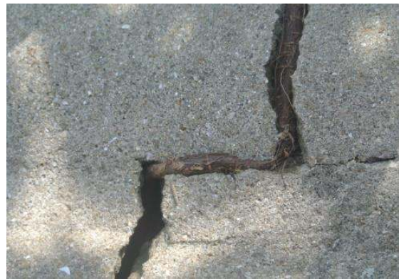
照片 3-3-40：樹根已深入圍牆形成裂縫
