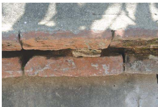
照片 3-3-41：磚縫灰漿劣化衰弱
