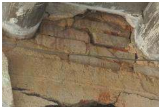
照片 3-3-16：桁木下粉刷層剝落，牆體有明顯裂縫照片
