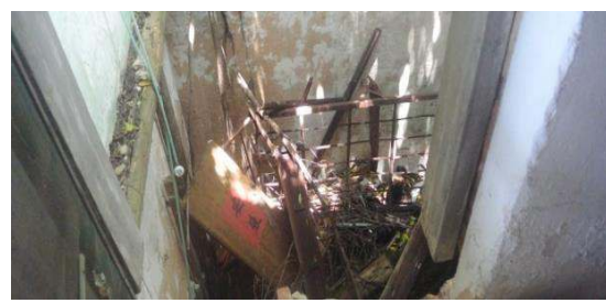
照片 3-3-30：右中房地坪完全塌落
