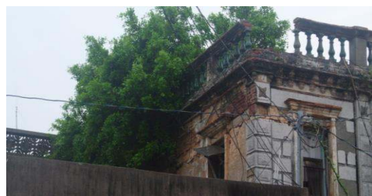
照片 3-3-11：右側屋頂附近水平裂縫 明顯、上方欄杆掉落及植生
