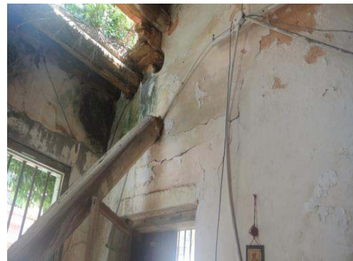
照片 3-3-36：後廳屋桁部分斷裂、屋頂部分塌落及牆壁裂縫
