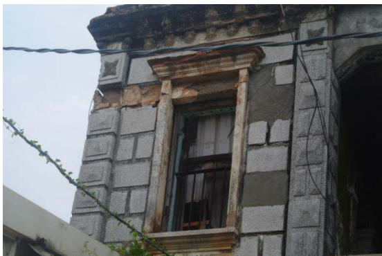
照片 3-3-15：正面右側面材剝落及修補、窗台上方有裂紋
