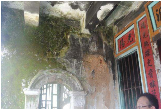
照片 3-3-27：二樓陽台上方樓板及樑體改 RC 構造，牆體有裂縫、剝落及斑駁
