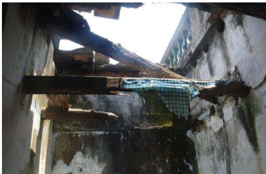
照片 3-3-33：左中房屋頂板塌落
