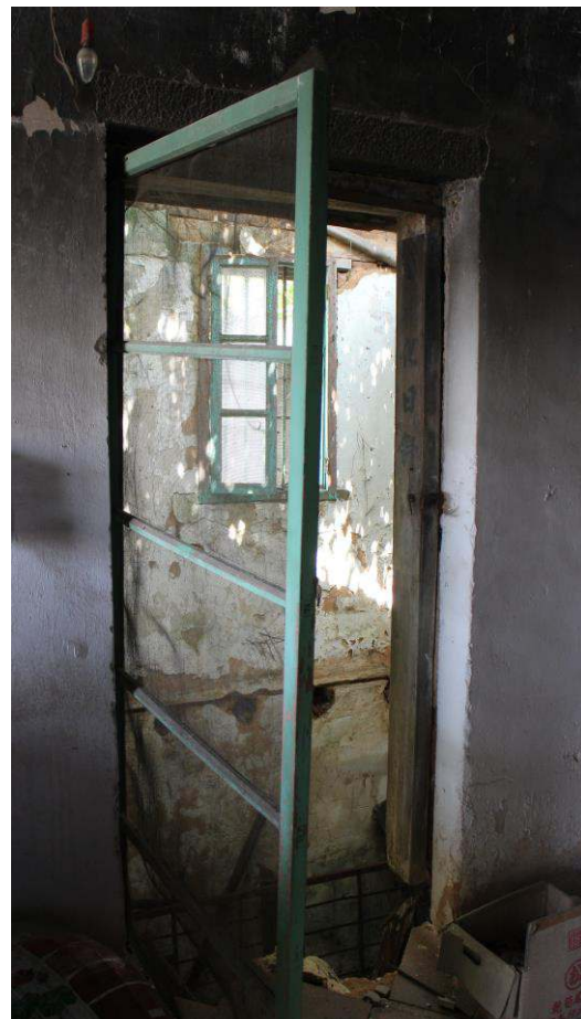
照片 3-4-6：D5 門板掉落一樓，剩紗門
