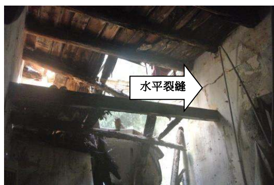
照片 3-3-21：左中房樓板部分塌落、桁木掉落及牆壁出現水平裂縫
