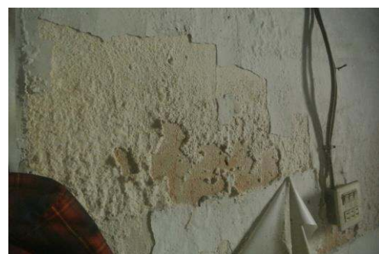
照片 3-3-22：前廳的牆壁白華及剝落
