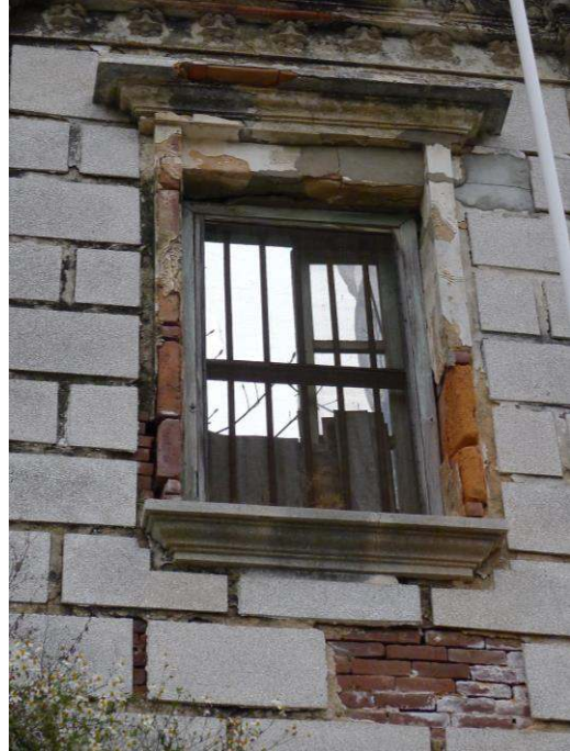
照片 3-4-8：W3 損壞後一部掉落現場
