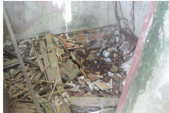
照片 3-3-28：右前房地坪塌陷
