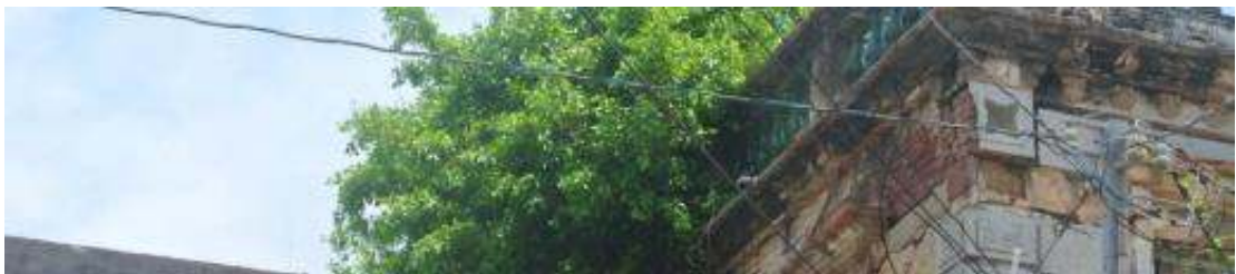
照片 3-3-1：二樓上方表層脫落，柱及牆可見磚塊堆積
