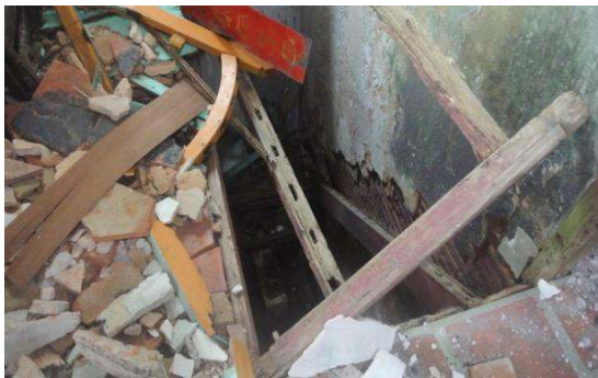
照片 3-3-35：內廊木作樓梯腐朽損毀掉落現場
