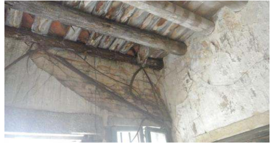
照片 3-3-26：後廳桁木腐朽嚴重、牆壁剝落及植物氣根盤繞，侵害至牆體
