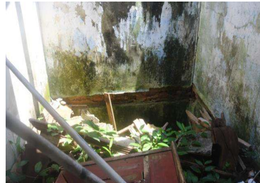
照片 3-3-34：左中房地坪塌陷
