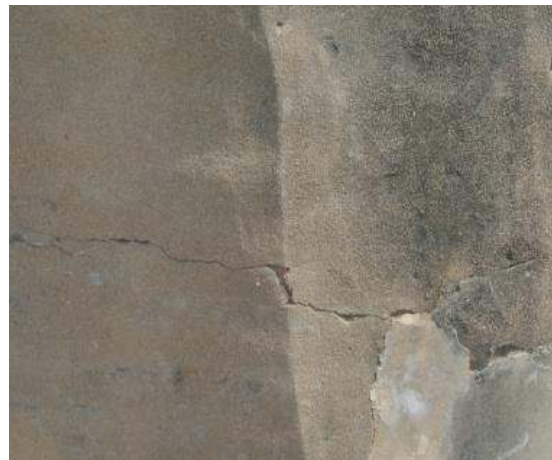
照片 3-3-38：圍牆有水泥砂漿修補過
