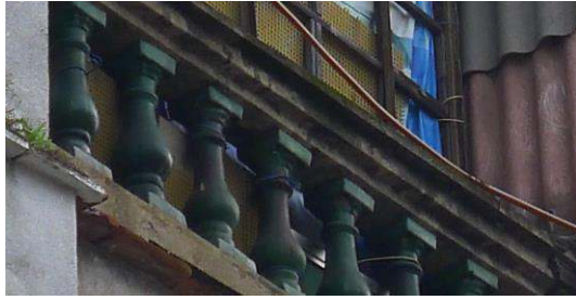
照片 2-3-3：水仙路尚保存綠釉花瓶欄杆 杆簷牆案例
