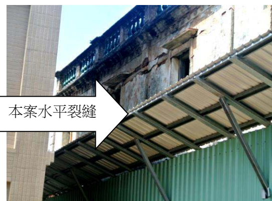
照片 3-3-9：左側二樓出現水平裂縫
